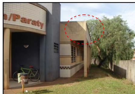
Figura 83 - Pintura em mau estado
