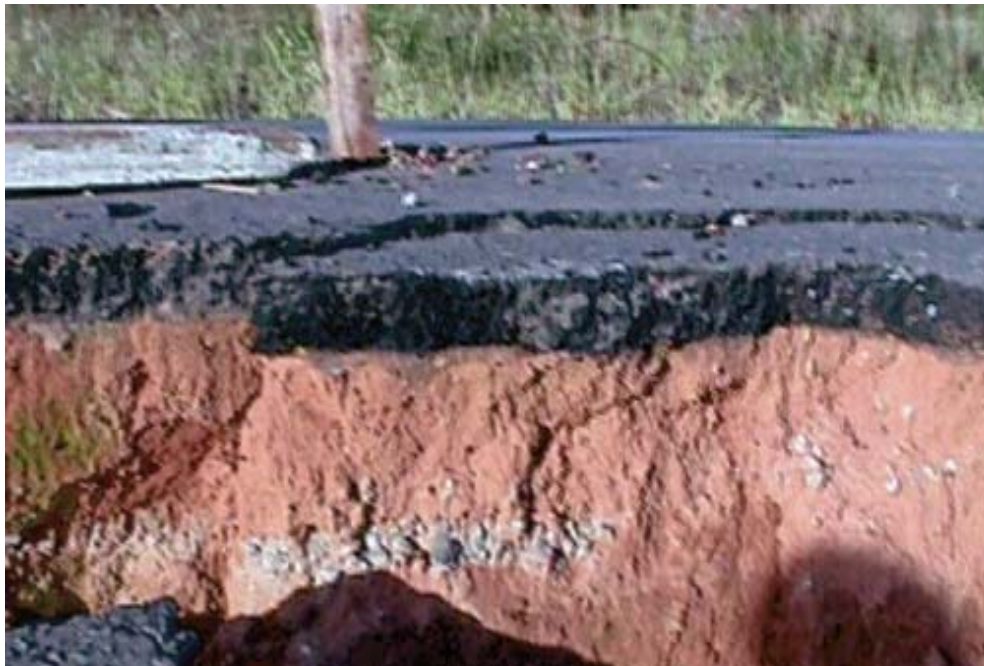
Figura 13 – Rompimento da base de solo estabilizado com cimento na BR-376/PR.
