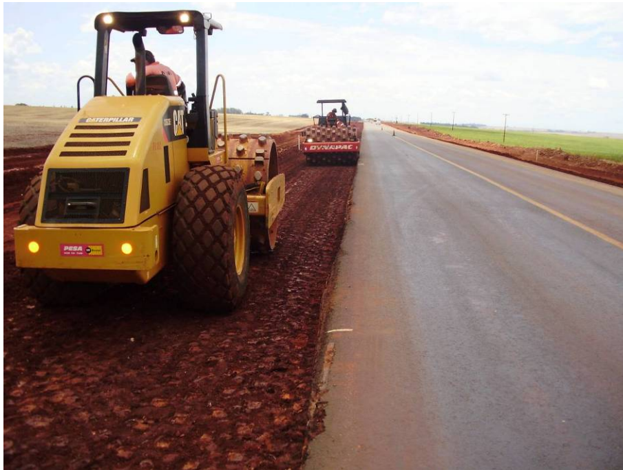
Figura 6 – Execução de compactação no solo com finalidade de estabilização nas obras para adequação da BR-163/PR no seguimento entre Guaíra e Mercedes no km 321.
