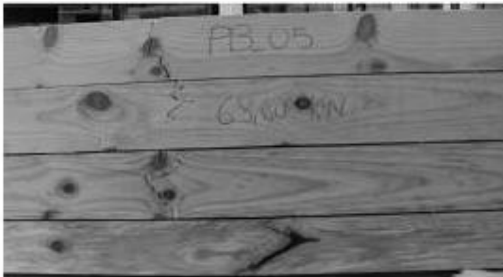
Figura 27. Ruptura do painel CLT no alinhamento dos nós. Fonte: CONCU et al (2013).
