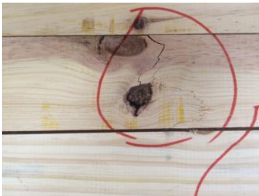
Figura 59. Painel PPP grupo 3, detalhe da ruptura no nó. Fonte: autor.
