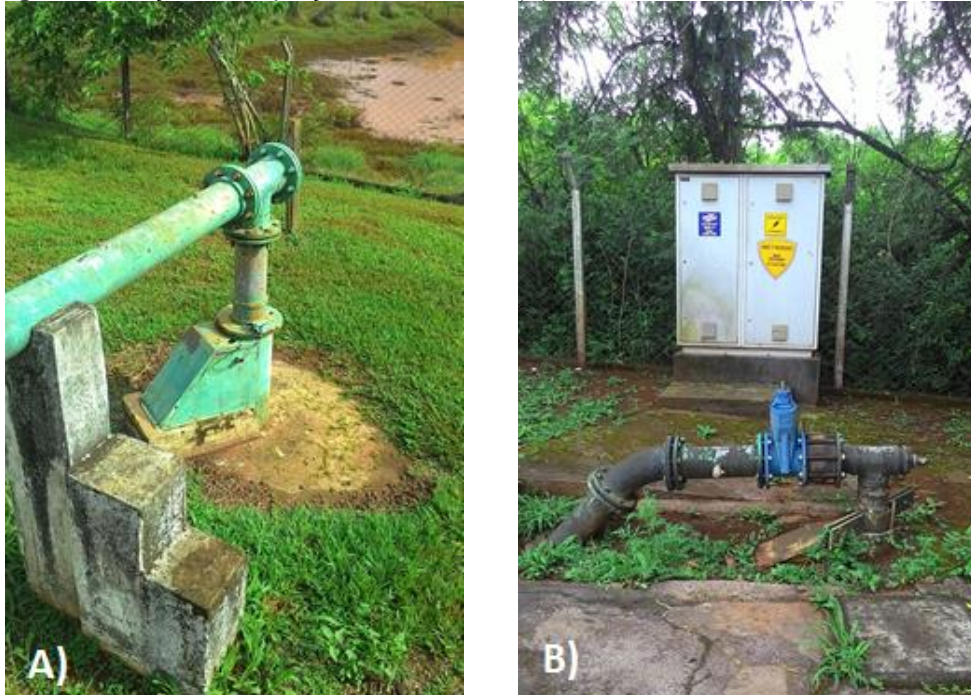
Figura 4 - Poços de Captação tubulares da (A) EET Vivi Xavier e (B) EEB João Paz
