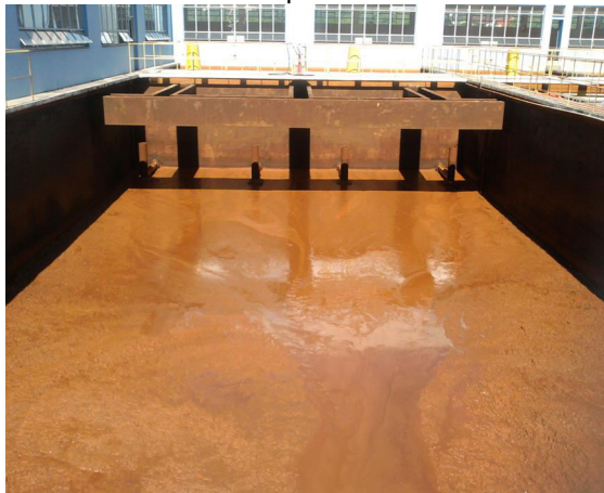
Figura 13 - Lodo acumulado no decantador convencional após esvaziamento completo para limpeza
