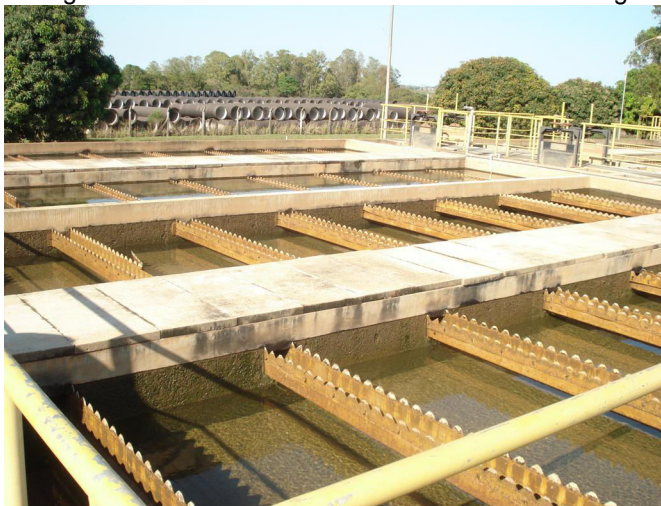
Figura 15 – Decantadores de alta taxa da ETA Tibagi
