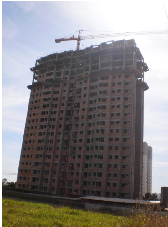
Foto 3 - Vista parcial do Residencial Solar Alta Vista. Edifício em construção sob responsabilidade da Yticon Construção e Incorporação Ltda. Localizado no Parque Aurora, porção sudoeste da cidade. Contará com 27 pavimentos e área de 22.847,47m 2 .
