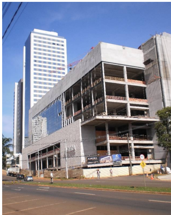
Foto 10 - Vista parcial do Aurora Shopping. Empreendimento localizado na Avenida Ayrton Senna da Silva – Gleba Palhano, sob responsabilidade da Galmo Engenharia, com 61.000 m 2 de área construída. Fonte: NASCIMENTO, 2014
