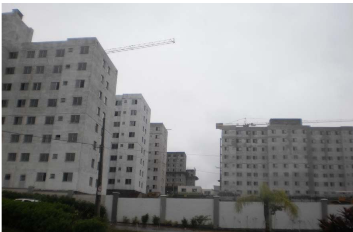
Foto 12 - Vista parcial do Residencial Leopoldina. Localizado no alto da Rua Faria Lima, próximo a UEL. A MRV está construindo 14 torres com 8 pavimentos cada, totalizando 49.522,74 m 2 .
