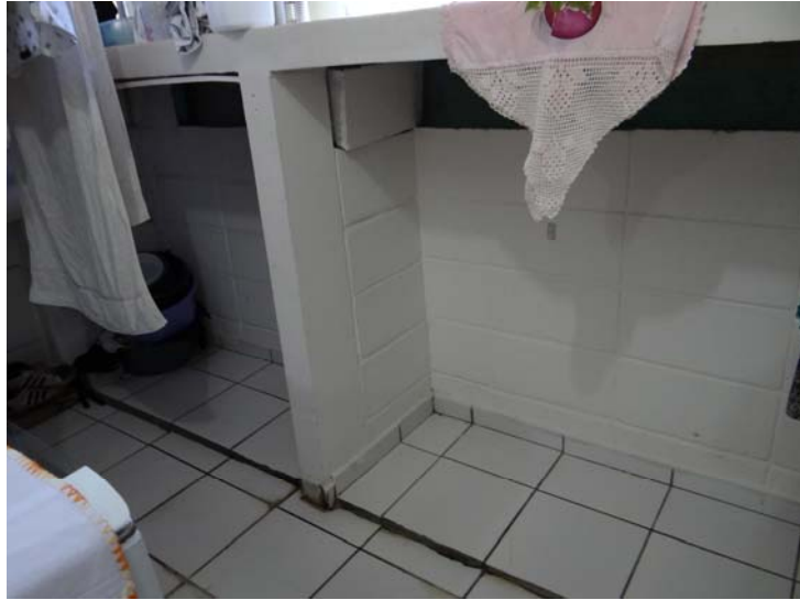
Figura 132 –CECAP Maria Izabel - Marília/SP - Armários Vista Interna - Vedação em bloco de concreto
