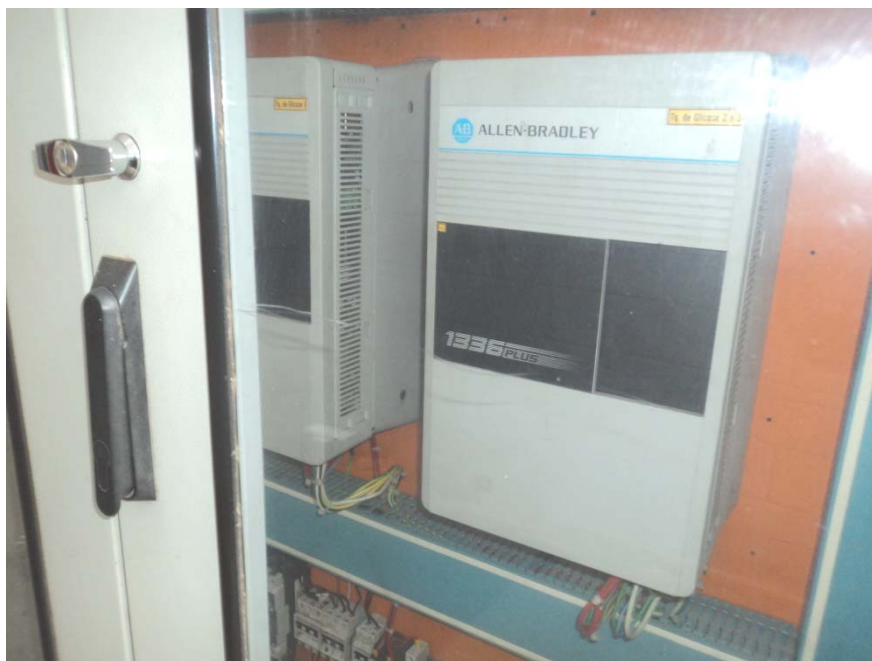
Figura 10 – Inversor de Freqüência para acionamento de motobombas
