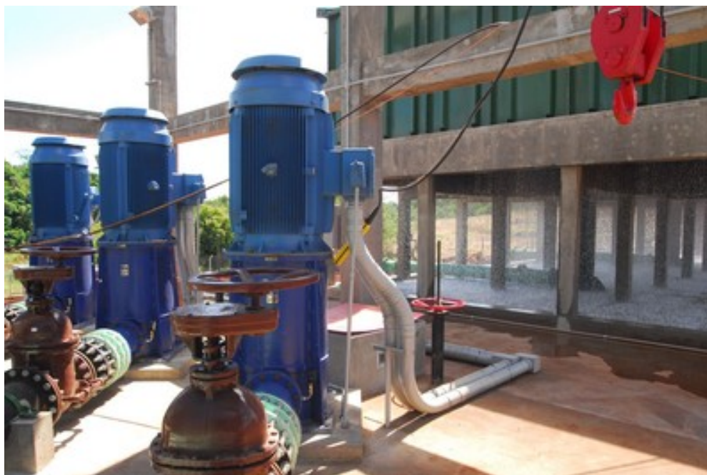
Figura 14 – Conjunto motobombas da estação elevatória Vivi Xavier.
