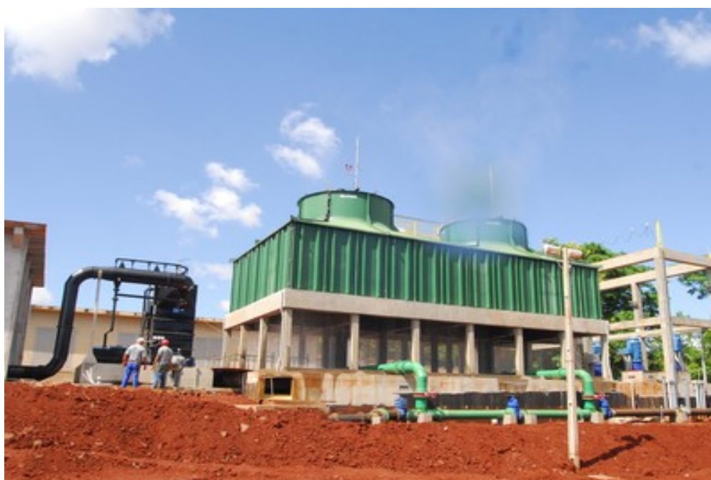
Figura 12 – Estação Elevatória de Vivi Xavier – Londrina/PR
