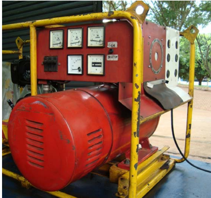
Figura 3.2 – Gerador a diesel de 10kVA.
