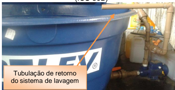
Figura 24 – Sistema de lavagem do FAP: reservatório de água para lavagem e bomba centrífuga Eletroplas (ICS-50B)
