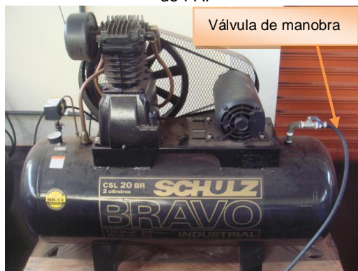
Figura 27 – Moto-compressor de ar (SCHULZ CSL 20 BR) utilizado para aplicação de ar durante a lavagem do FAP
