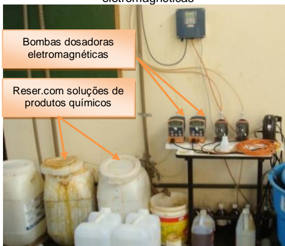
Figura 15 – Foto dos reservatórios com soluções de produtos químicos e bombas dosadoras eletromagnéticas
