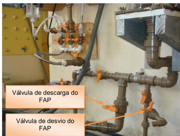
Figura 22 – Válvulas de manobras do sistema de FAP
