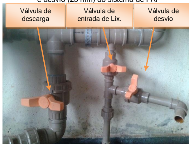
Figura 23 – Tubulações de descarga de fundo (50 mm) e desvio (25 mm) do sistema de FAP
