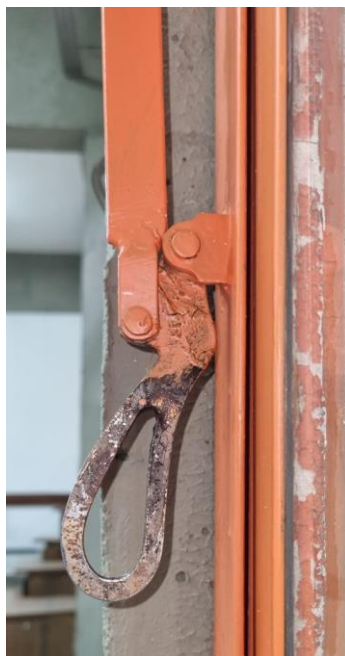
Figura 26 – Alavanca para operação das esquadrias basculantes
