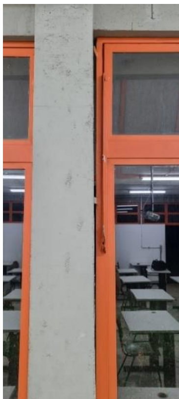
Figura 25 – Vão entre esquadria e estrutura de concreto
