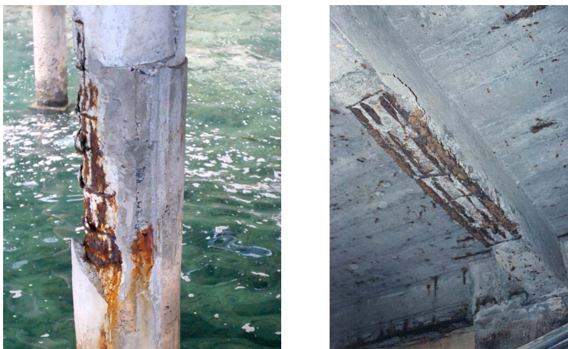
Figura 2 – Exemplos de pilar e viga com armadura em estágio avançado de corrosão resultando no lascamento do concreto (extraído de LIMA, 2010).
