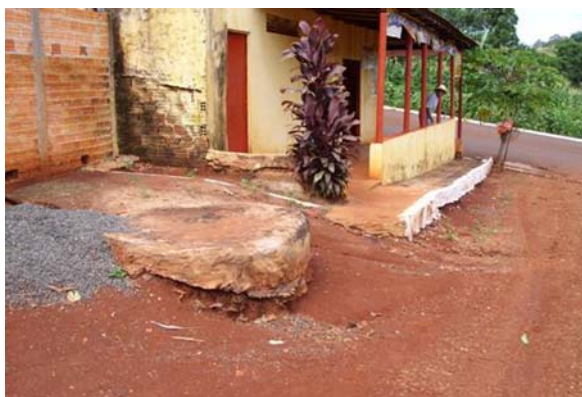
Figura 5 - Fossa com construção elevada devido profundidade do solo e a presença de rocha na área urbana
