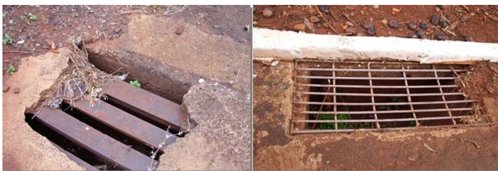
Figura 8 - Dispositivos de Drenagem - ausência de padrão construtivo e impossibilidade de manutenções
