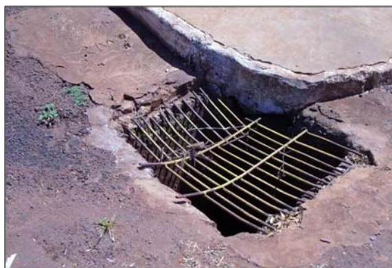
Figura 18 - Precariedade dos dispositivos de drenagem
