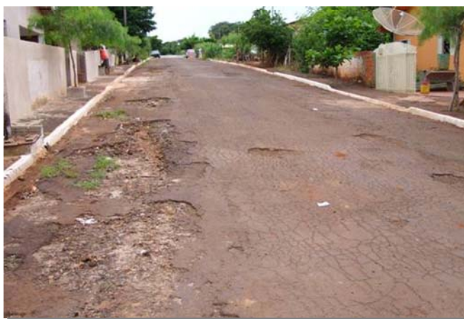
Figura 11 - Problemas de erosão da pavimentação devido à ineficiência do sistema de drenagem
