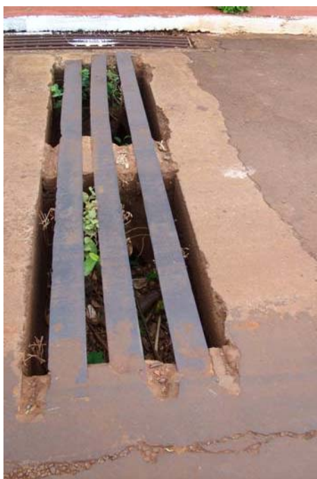
Figura 10 - Dispositivo de Drenagem - (grade fixa e impossibilidade de manutenções)
