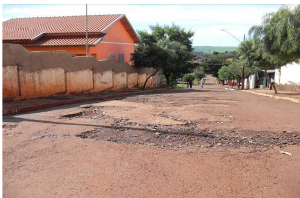
Figura 4 - Problemas de erosão na pavimentação da área urbana de Santa Cecília do Pavão provocados pelo escoamento da água pluvial
