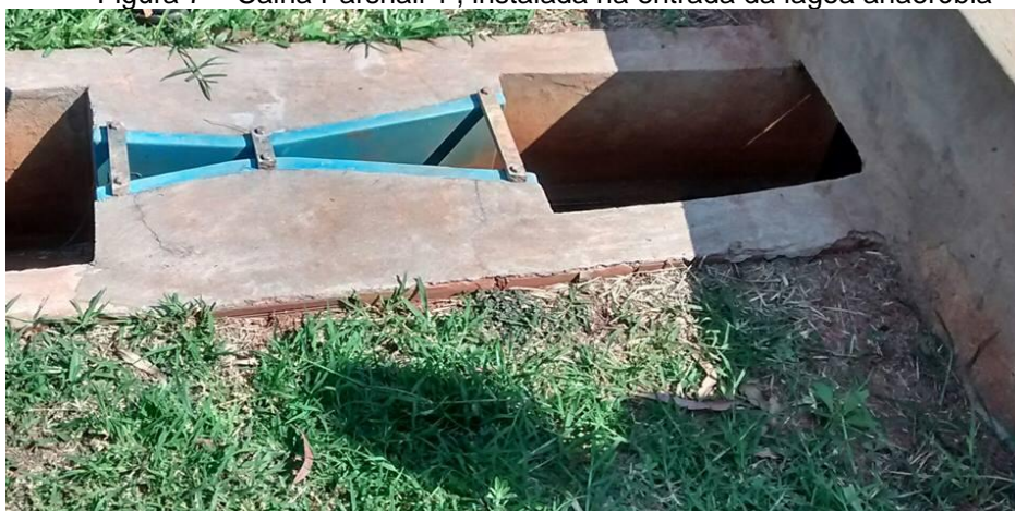
Figura 7 – Calha Parshall 1', instalada na entrada da lagoa anaeróbia
