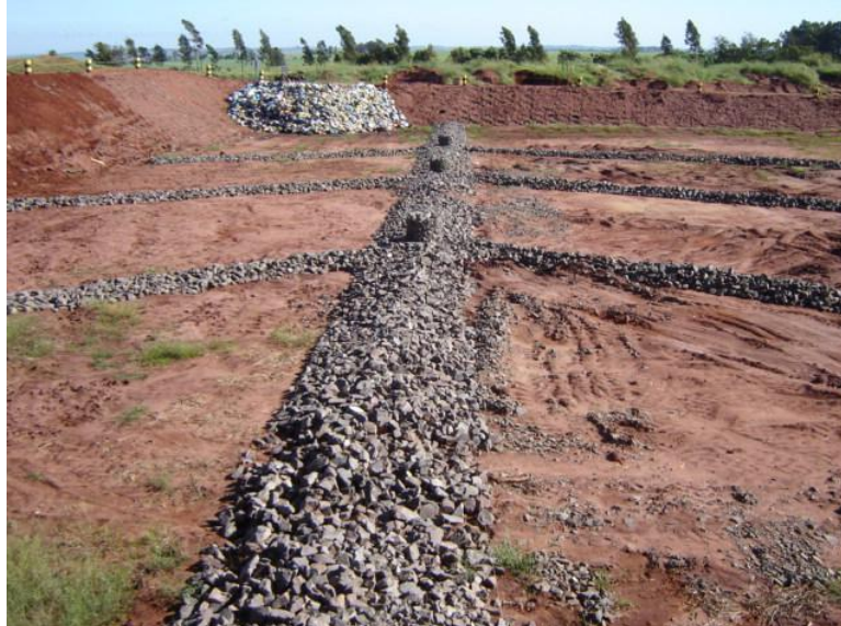
Figura 3 – Dreno horizontal de lixiviado na base de construção da célula 4 do aterro de Cianorte-PR
