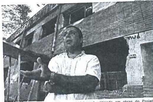
CEUEL está sendo demolida e material será utilizado em obras do Projeto Onde Moras em Londrina e Ibitiporã informa o engenheiro Maurício Costa
