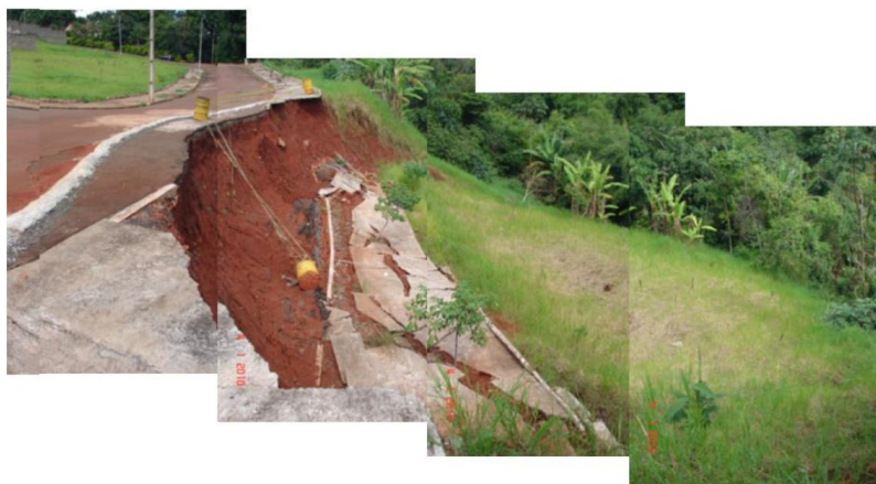
Figura 23 – Registro de campo da ruptura do talude utilizado neste estudo.
