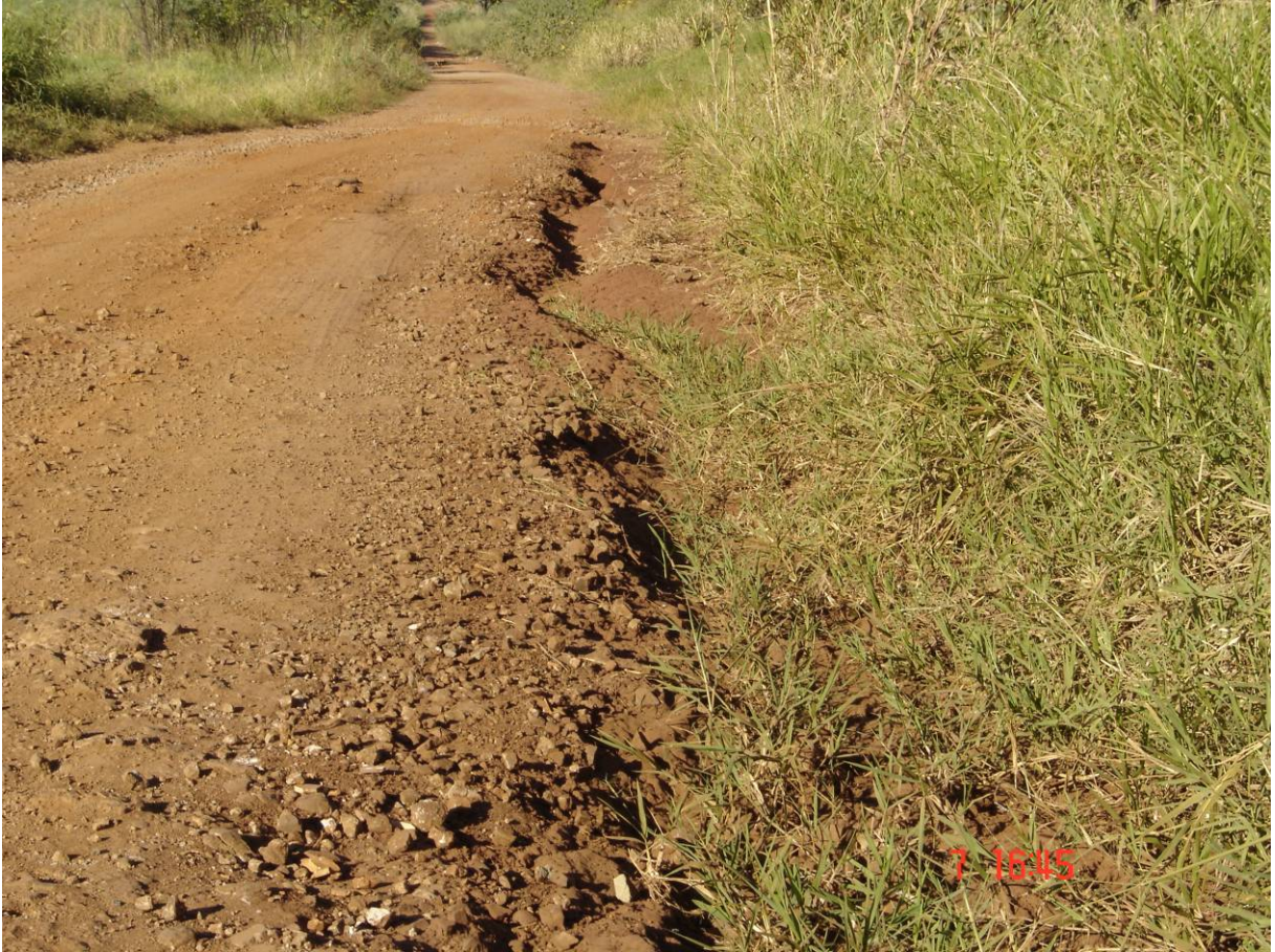
Foto: Erosão nas Estradas Rurais da Microbacia do Ribeirão Jacutinga (2005).
