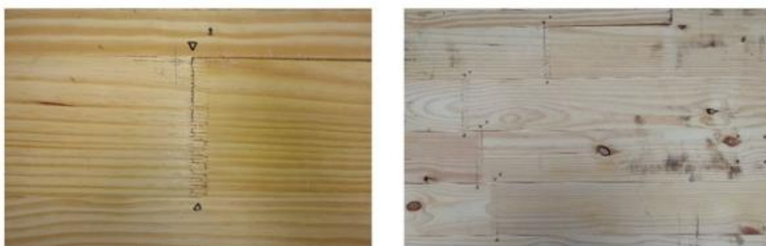
Figura 20 Ruptura dos painéis nas emendas dentadas. Fonte: VILELA (2020)
