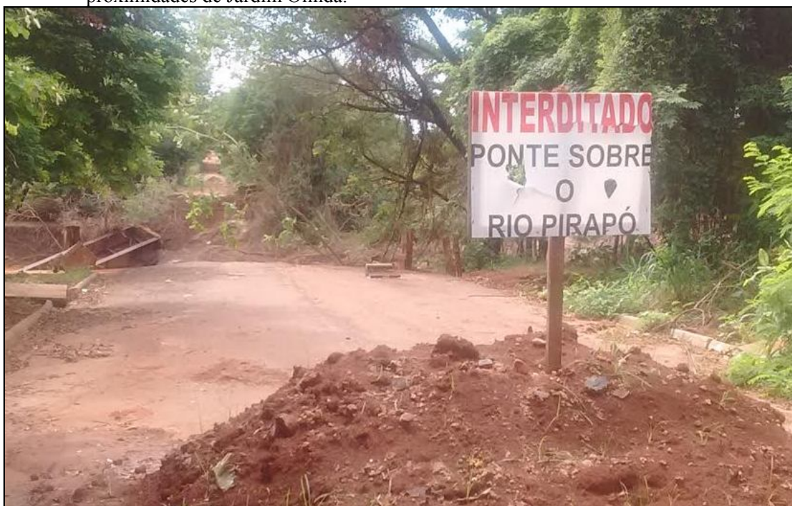
Figura 03. Ponte interditada devido à destruição da mesma no início do ano de 2016, nas proximidades de Jardim Olinda.
