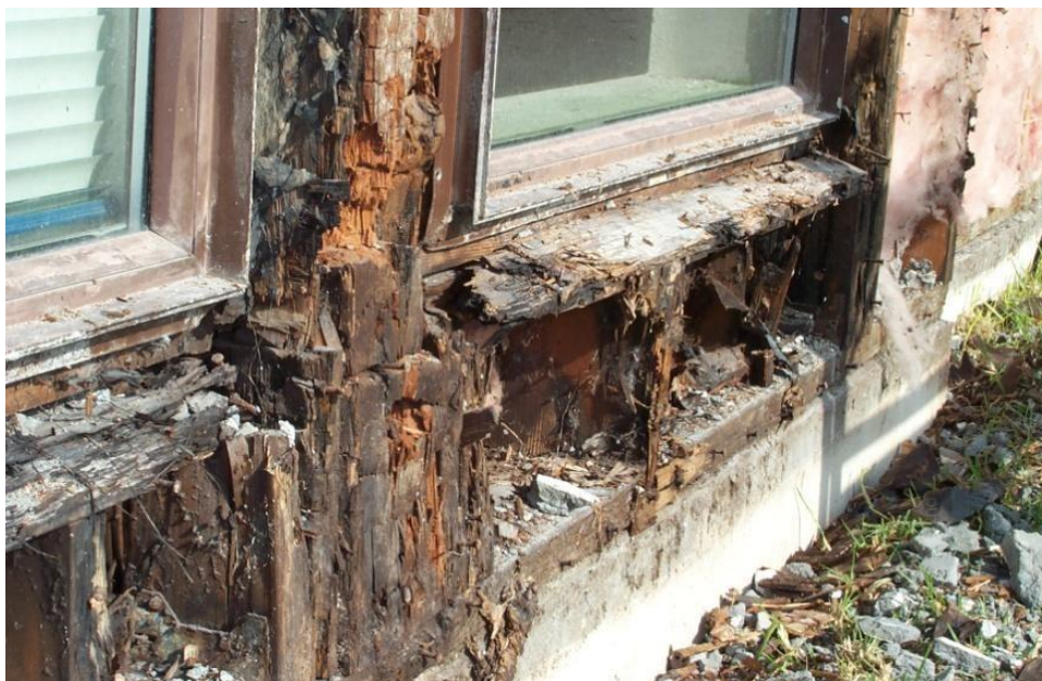
Figura 26 - Apodrecimento da estrutura de madeira
