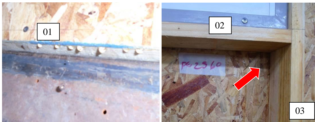
Figura 76 - Infiltração de água
