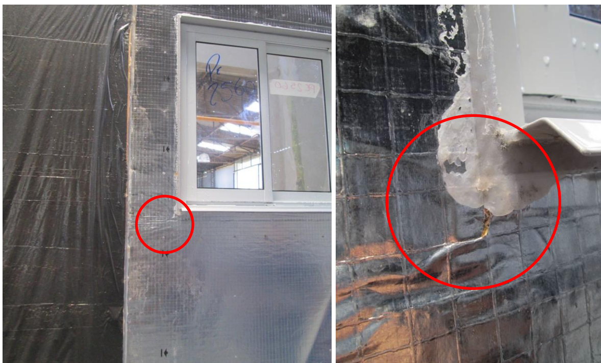
Figura 80 - Falha na membrana aluminizada (detalhe)
