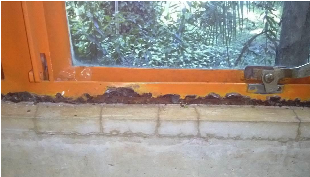
Figura 25 - Infiltração na base da esquadria provocou oxidação
