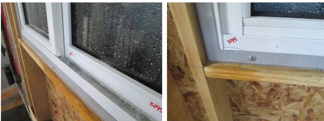
Figura 95 - Infiltração de água no trilho inferior da esquadria
