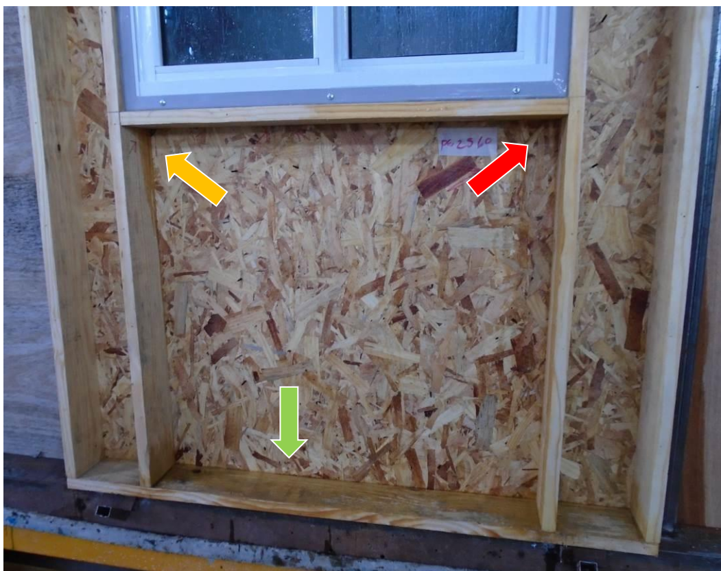
Figura 77 - Infiltração de água: detalhe 2
