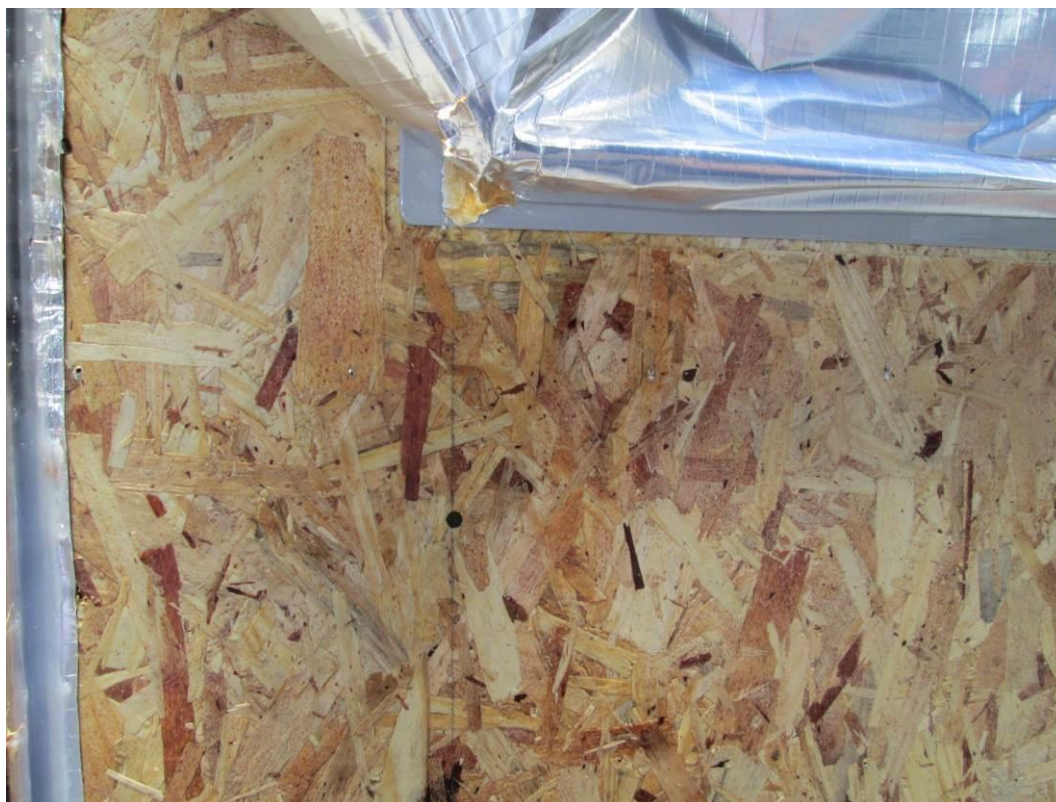
Figura 82 - Ponto de infiltração
