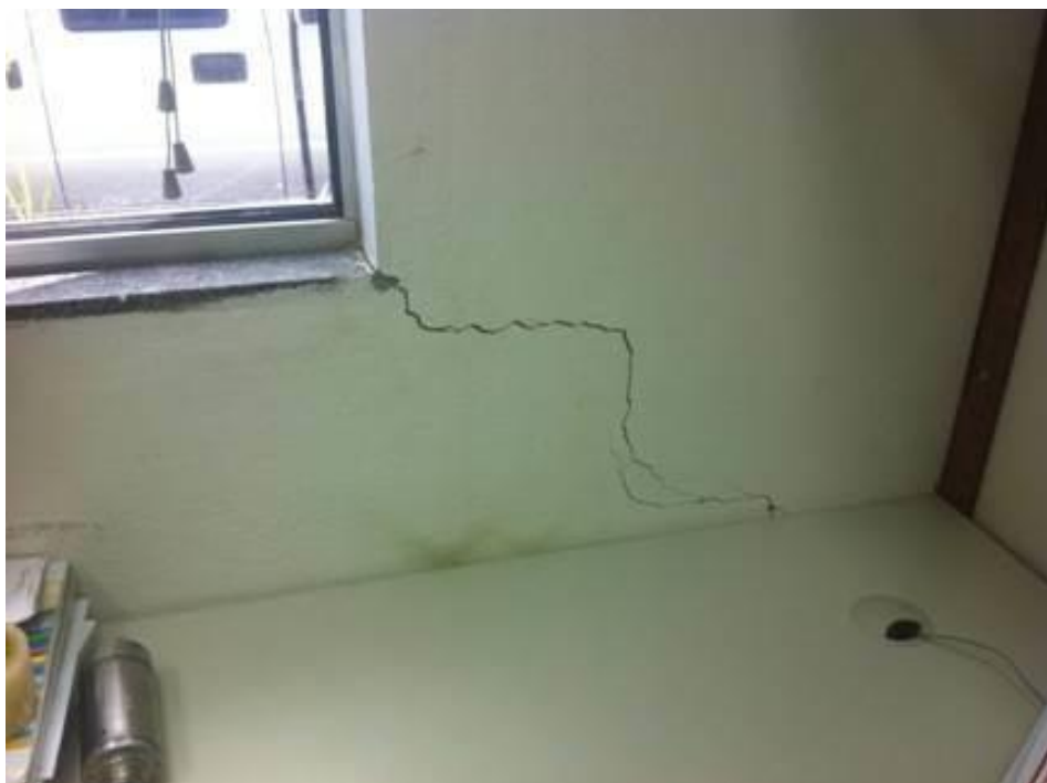
Figura 24 - Rachadura na parede
