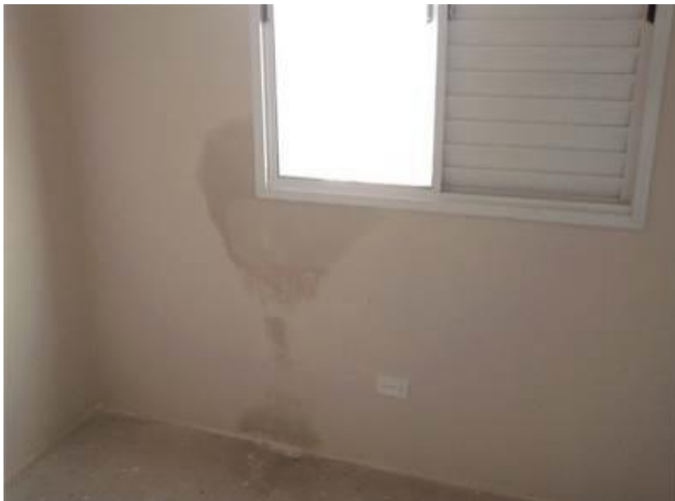
Figura 20 - Infiltração interface parede x esquadria
