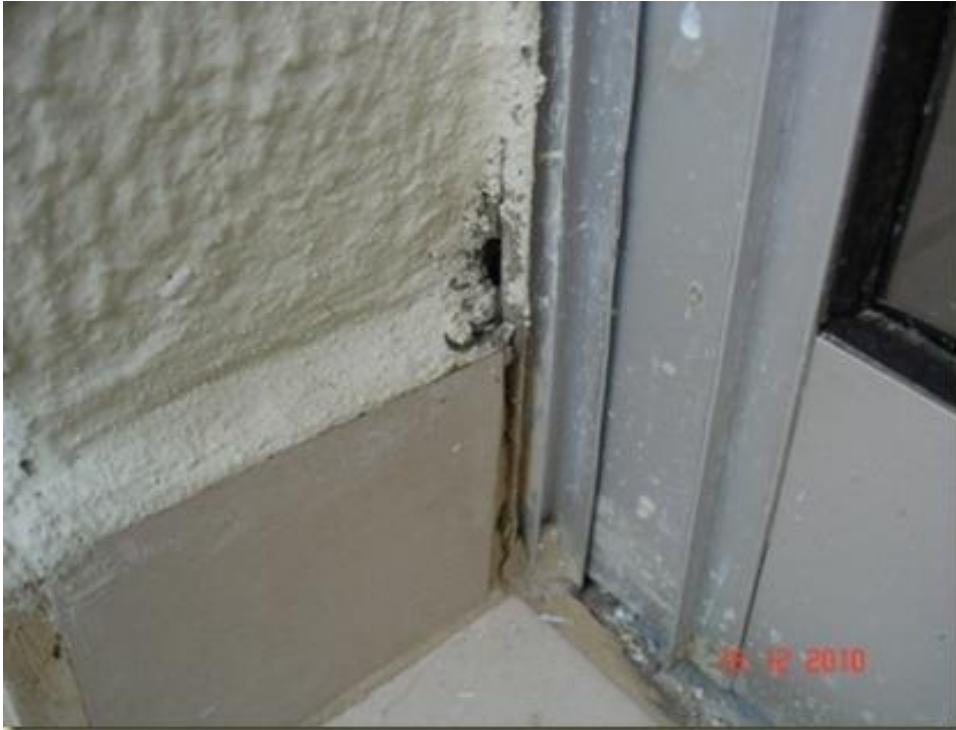
Figura 23 - Falha do preenchimento no requadro
