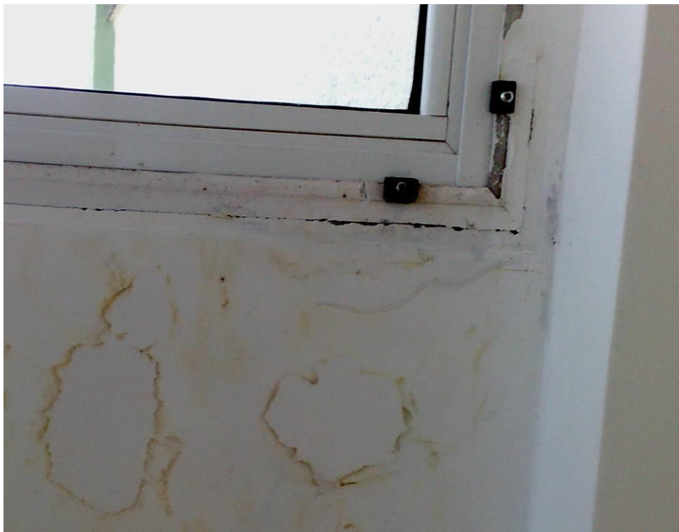
Figura 21 - Infiltração pela base do contramarco
