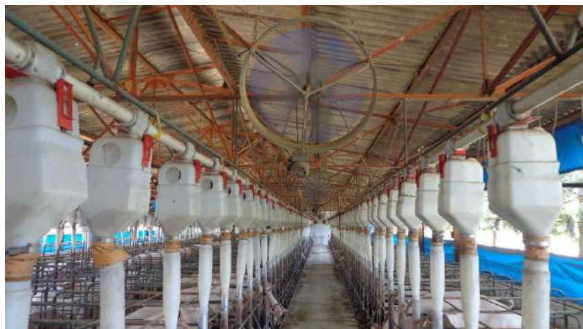
Figura 54- Pavilhão de gestação semi-climatizado. Sistema de ventilação com ventiladores posicionados no corredor central associado com nebulização.
