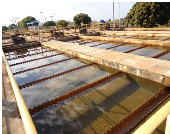
Figura 3 - Decantadores da ETA-Tibagi
