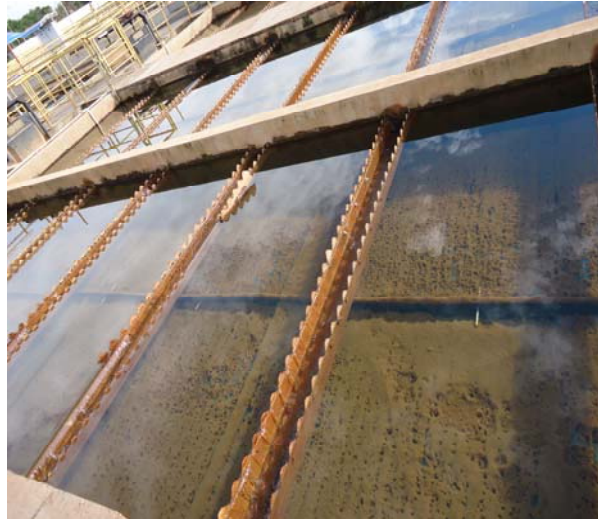
Figura 9 – Lodo acumulado no fundo do decantador da ETA-Tibagi
