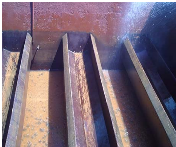
Figura 12 – Lavagem do filtro ETA-Cafezal
