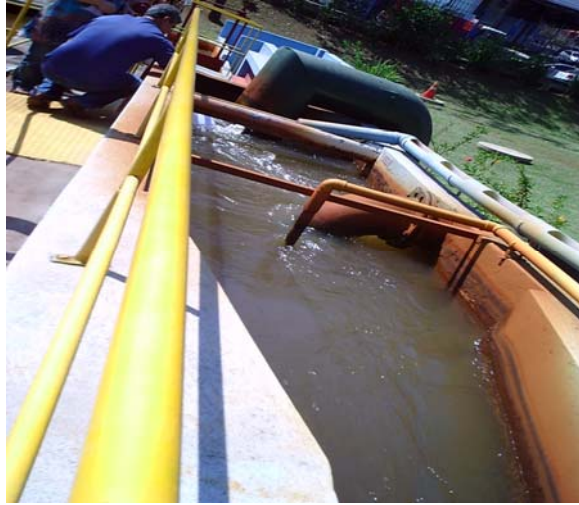
Figura 6 - Entrada da água bruta na ETA-Cafezal
