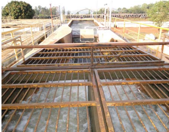
Figura 2 - Entrada da água bruta na ETA-Tibagi
