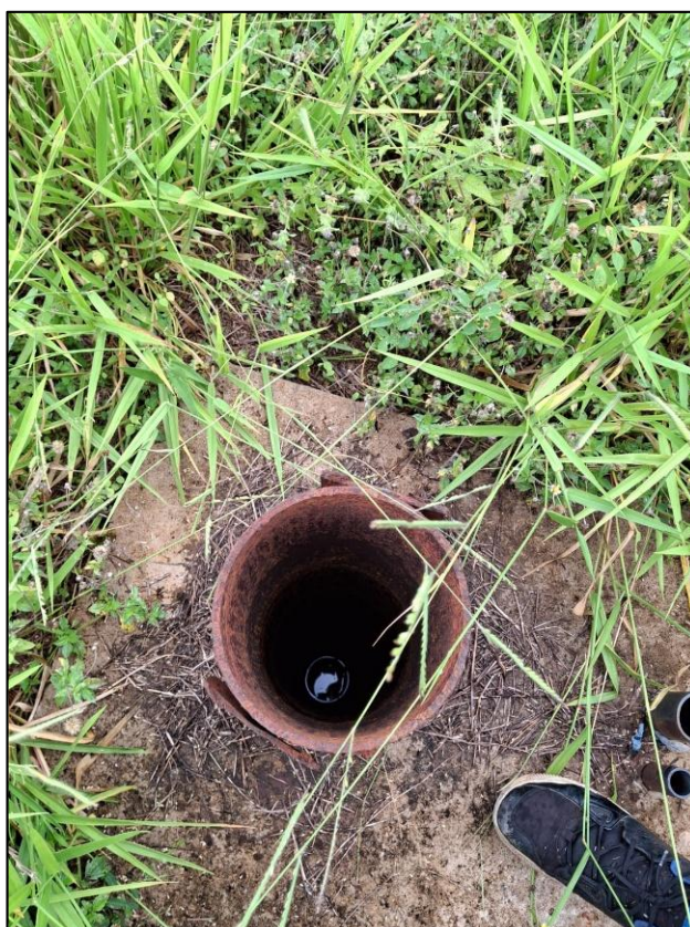
Figura 35 - Poço P213 abandonado, sem o devido tamponamento.
