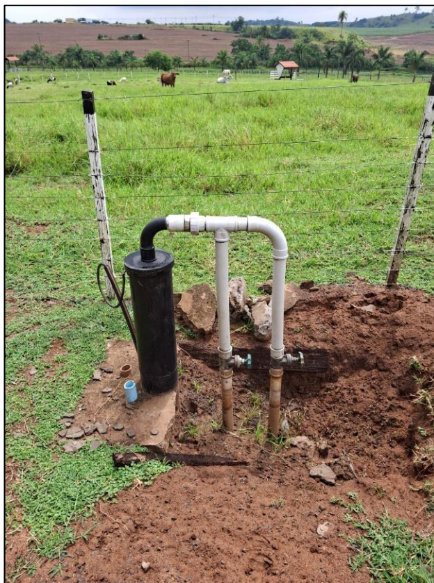
Figura 37 - Poço P218, localizado no município de Jacarezinho - PR.
