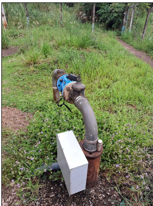
Figura 36 - Poço P217, localizado no município de Jacarezinho - PR.
