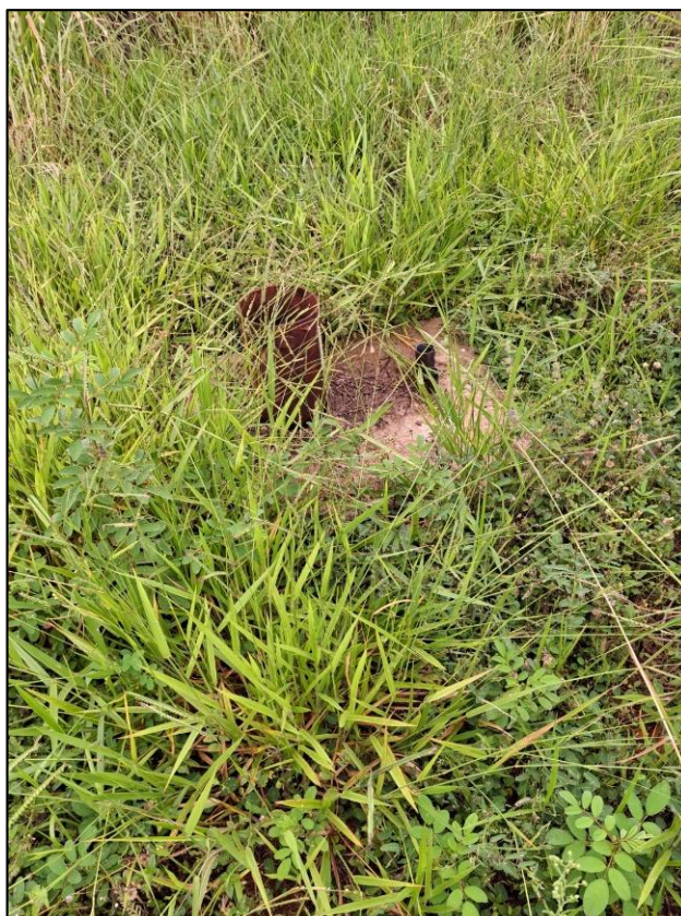
Figura 34 - Poço P213 abandonado, localizado no município de Jacarezinho - PR.
