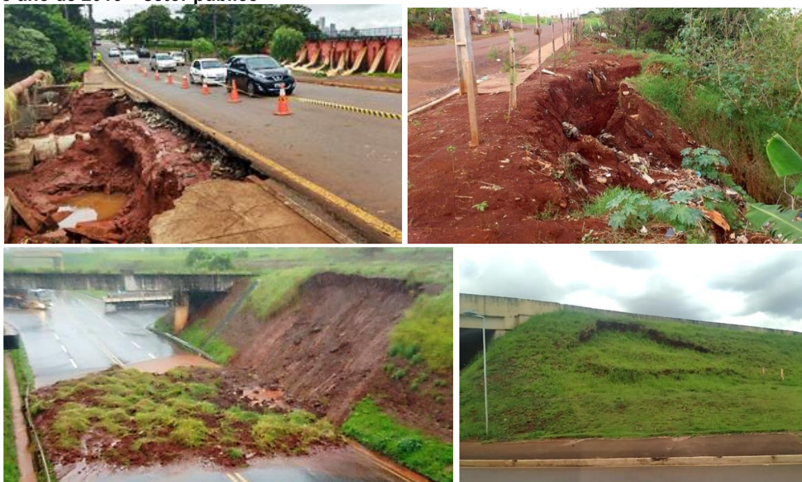
Figura 38 - Taludes escorregados após chuvas intensas na região de Londrina/PR no começo do ano de 2016 – setor público
