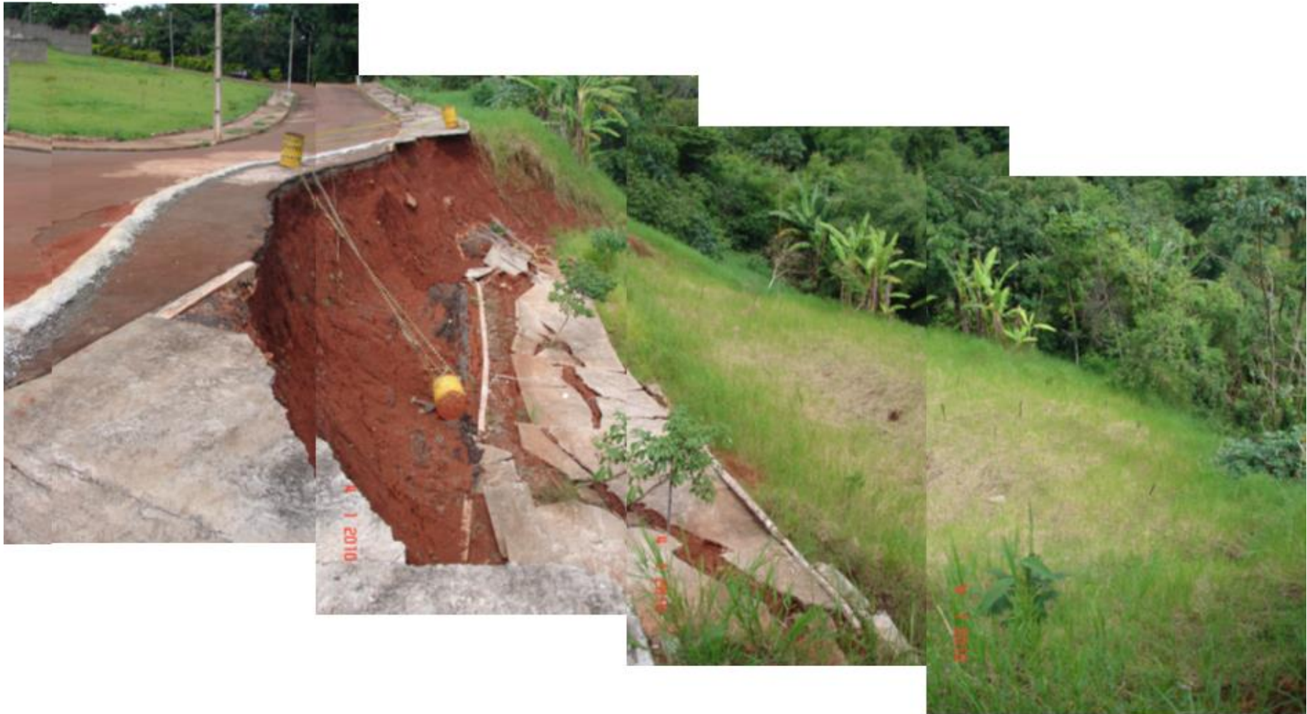
Figura 45 - Área de estudo – vista do talude real escorregado
