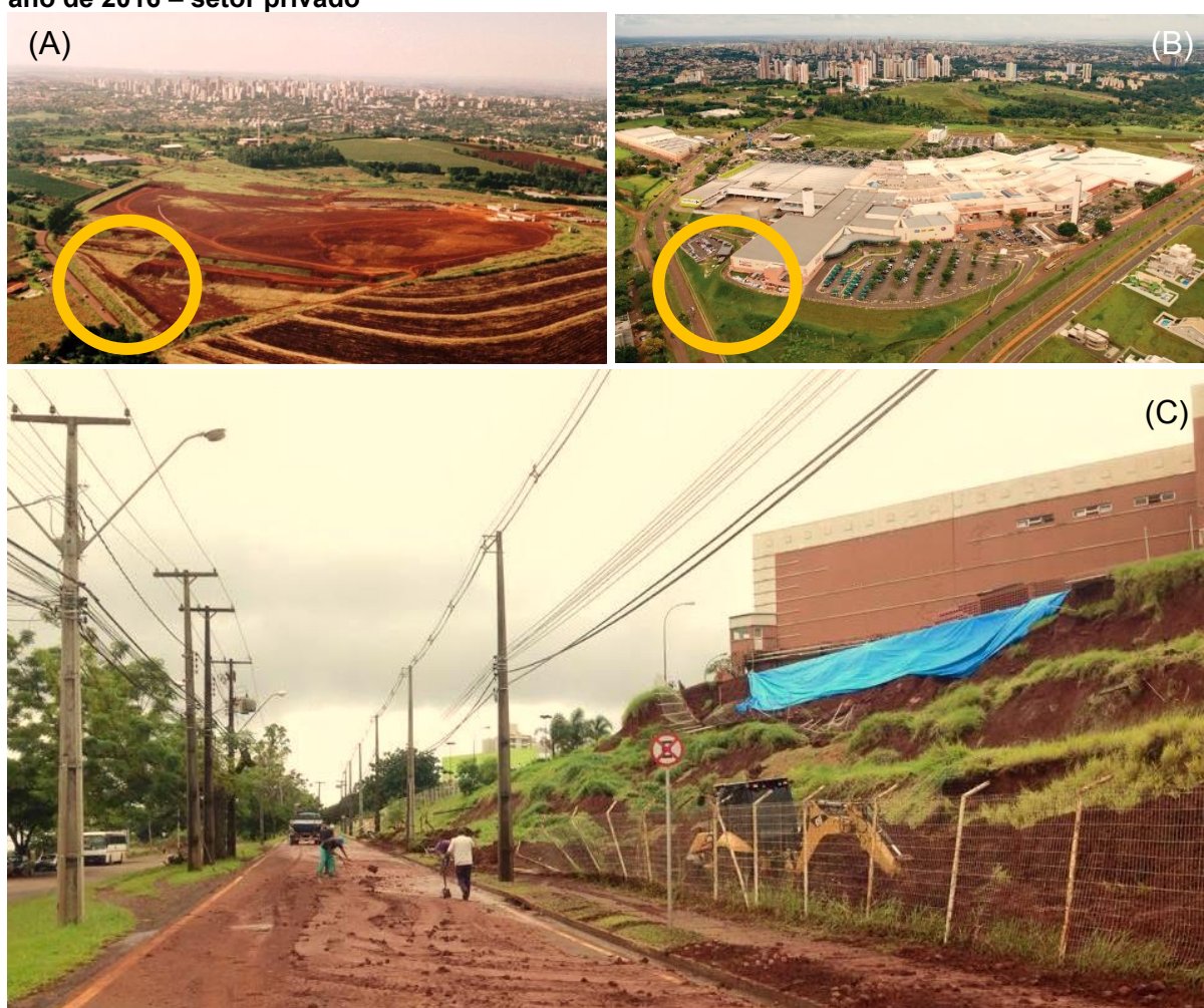
Figura 39 - Talude escorregado após chuvas intensas na cidade de Londrina/PR no começo do ano de 2016 – setor privado
