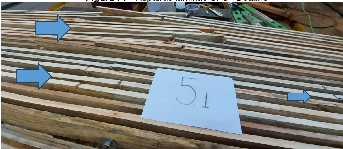
Figura 71 - Rupturas lâminas CP5 - Detalhe
