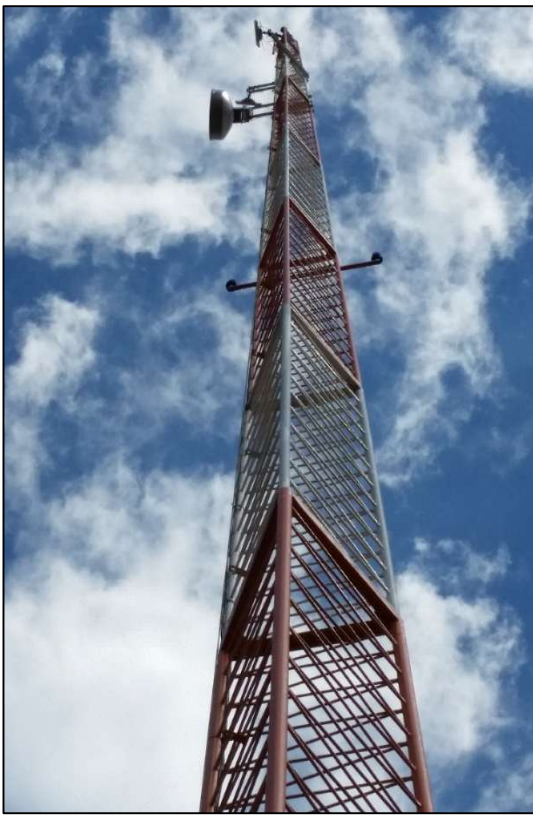
Torre Distribuição 40m. 24 H Alberto Kallas
