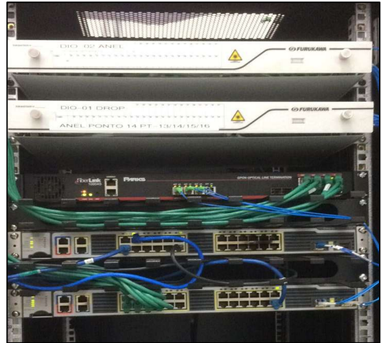
DIO / OLT / Switchs. 24 H Alberto Kallas
