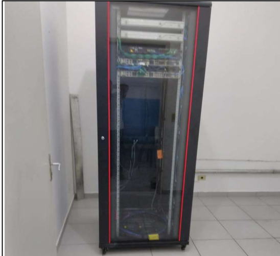
Rack Sala de Equipamentos. 24 H Alberto Kallas
