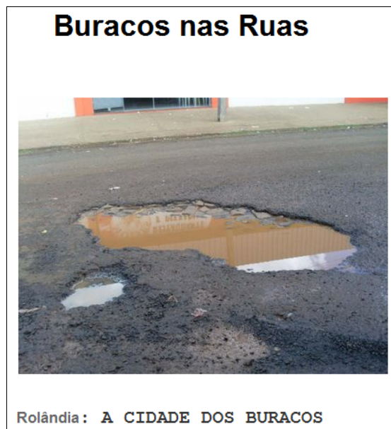
Figura 13 – Buracos nas ruas da cidade. 20
