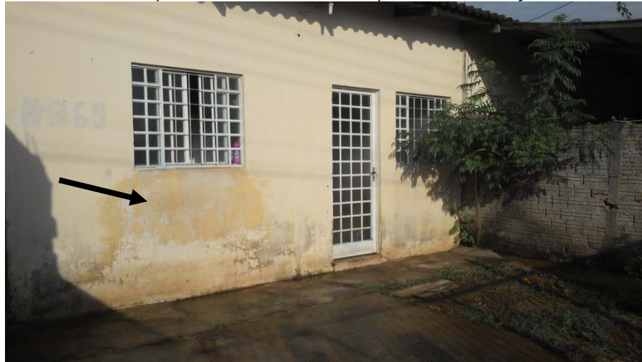
Figura 12 - Casa 06 com pintura deteriorada com a perda de cor e ação de umidade
