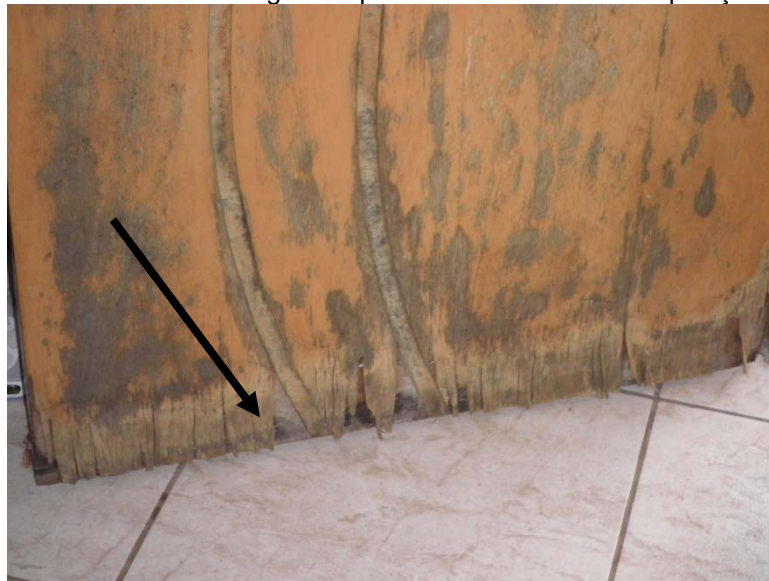
Figura 15- Casa 02 - Patologia nas portas de madeira: decomposição do material
