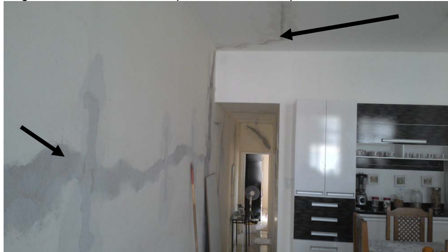
Figura 13 - Casa 37 com reparo de fissura na parede e na estrutura
