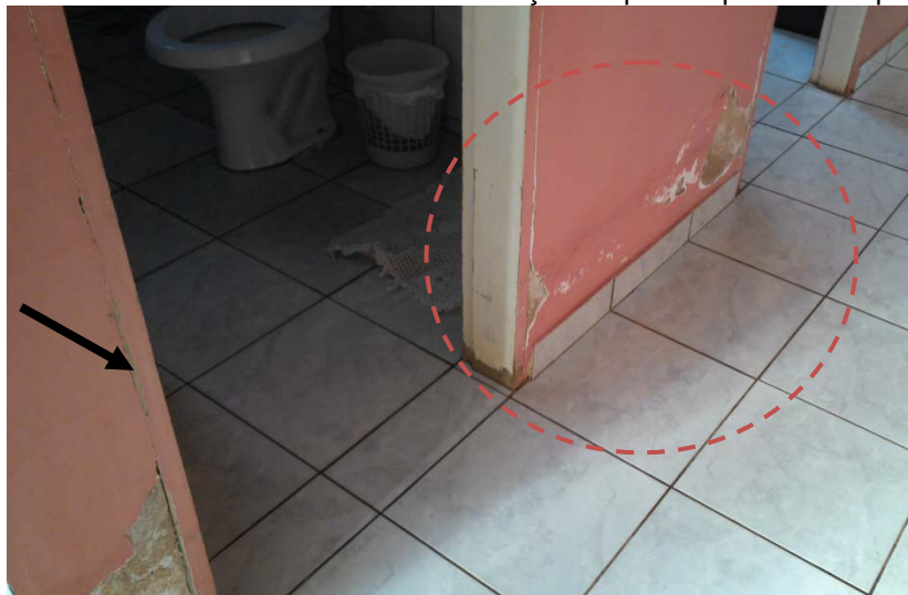
Figura 11 - Casa 40 com manchas e deterioração da pintura próxima ao piso
