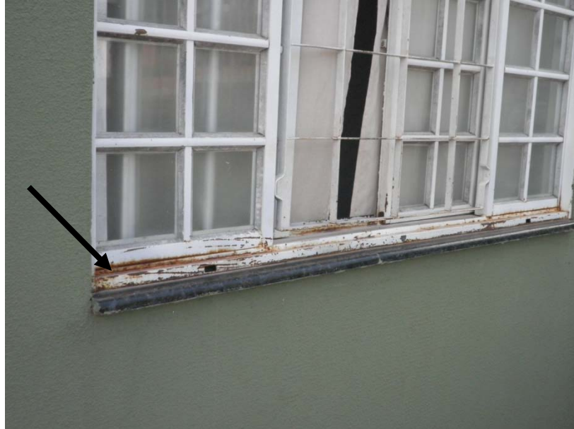
Figura 14 - Casa 05 - Patologia na janela, presença de corrosão no peitoril.
