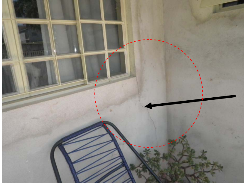
Figura 10 - Casa 35 com fissura na parede externa localizada junto à janela
