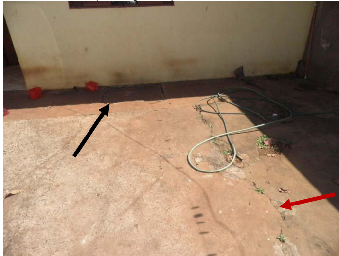
Figura 9 - Casa 14 com patologia no piso externo da residência
