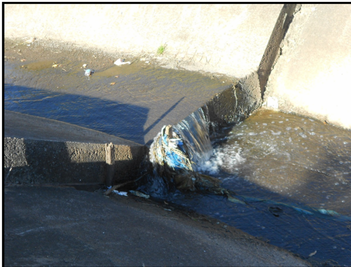
Foto 8 – Poluição difusa no Córrego da Mula canalizado, ao norte da malha urbana de Santa Fé do Sul.
