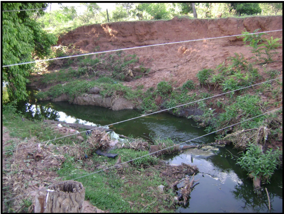
Foto 6 – Processos erosivos no Ribeirão Jacú Queimado ao sul da malha urbana de Santa Fé do Sul.
