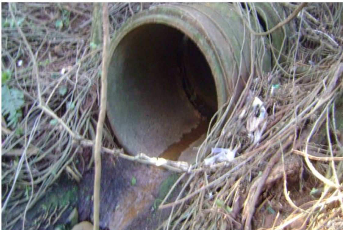
Figura 28 - Ponto 4 – Tubulação sem dissipador de energia – Jardim São Francisco de Assis, Londrina-PR.
