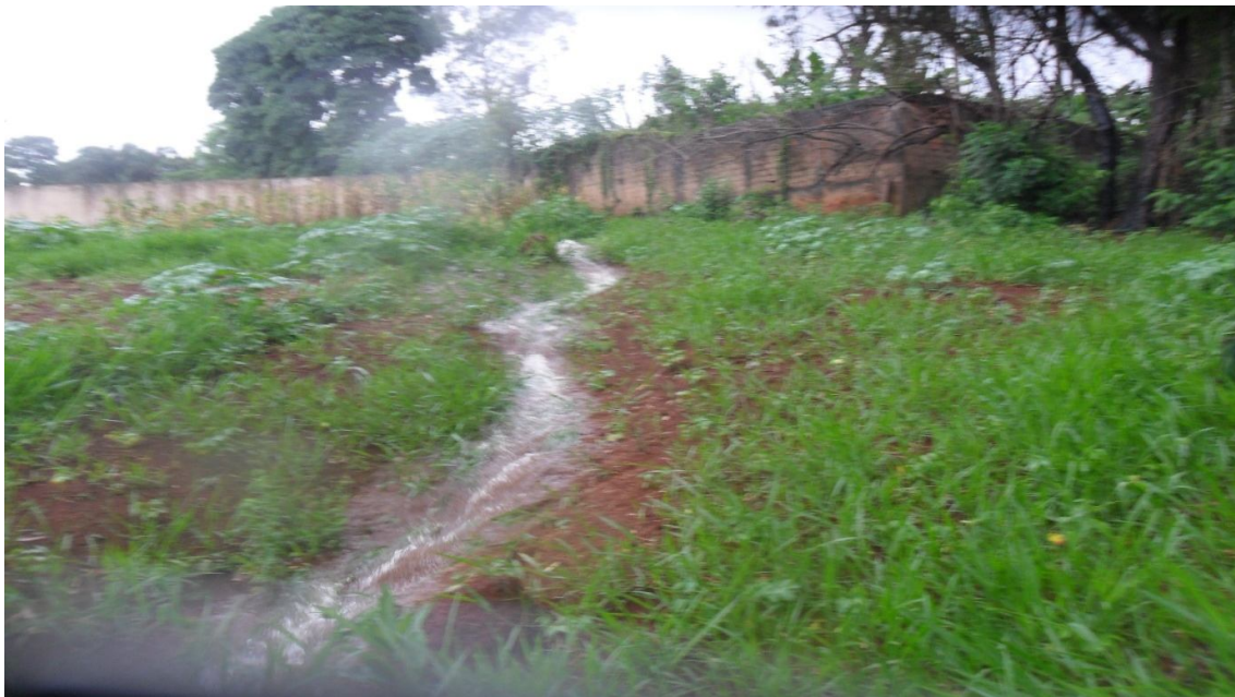
Figura 31 - Ponto 5.1 – escoamento pluvial da rua Isaías Canete, com extravasamento pela tubulação subdimensionada durante o período de chuva intensa
