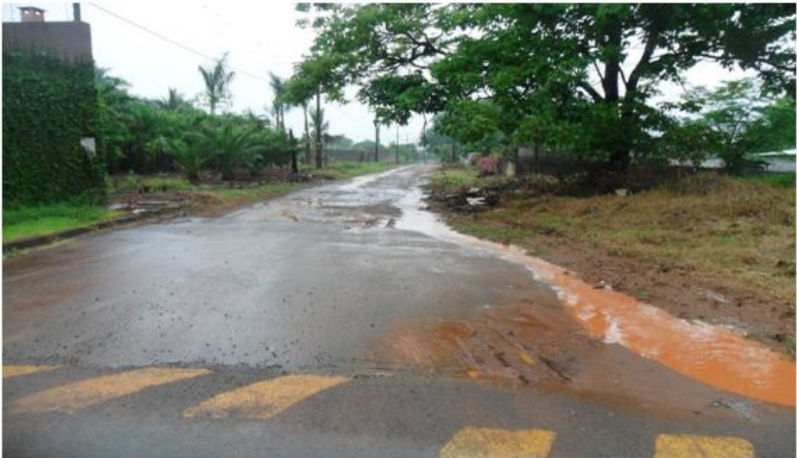
Figura 37 - Ponto 6 – escoamento pluvial em parte da rua Vital Brasil sem pavimentação asfáltica.
