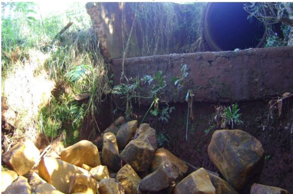
Figura 24 - Ponto 2 – Calha inclinada sem dissipador de energia Jardim Riviera, Cambé-PR.
