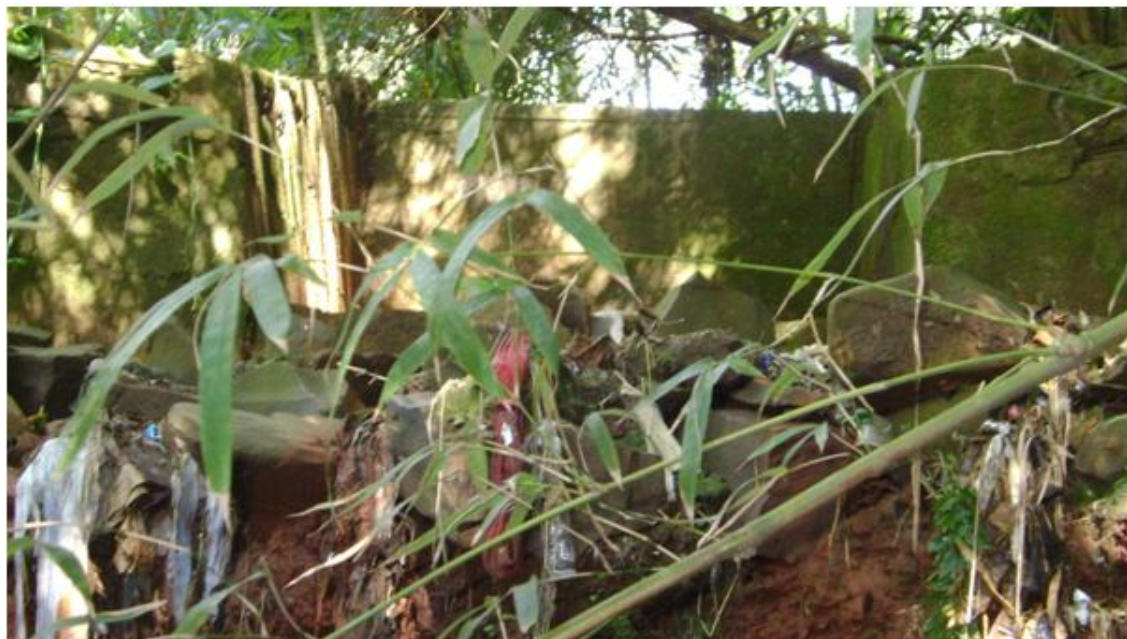
Figura 26 - Ponto 3 - Calha de escoamento pluvial sem dissipador de energia.
