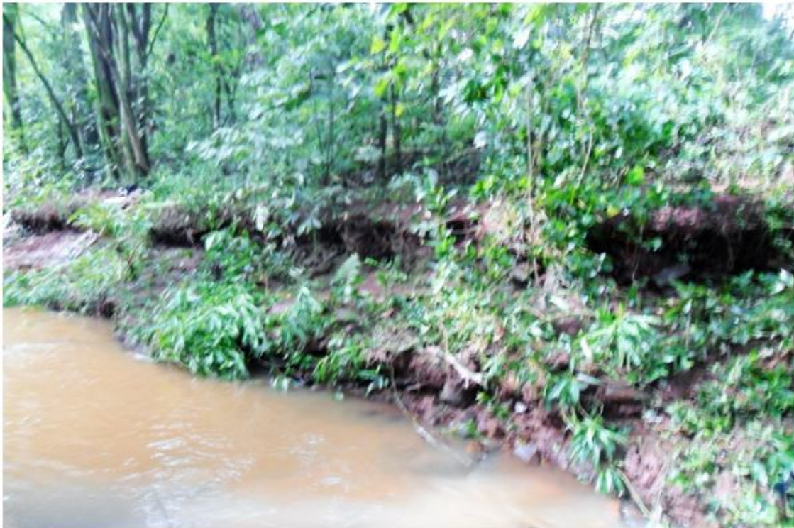
Figura 21 - Solapamento e dique marginal, margem direita do Ribeirão Cambé.
