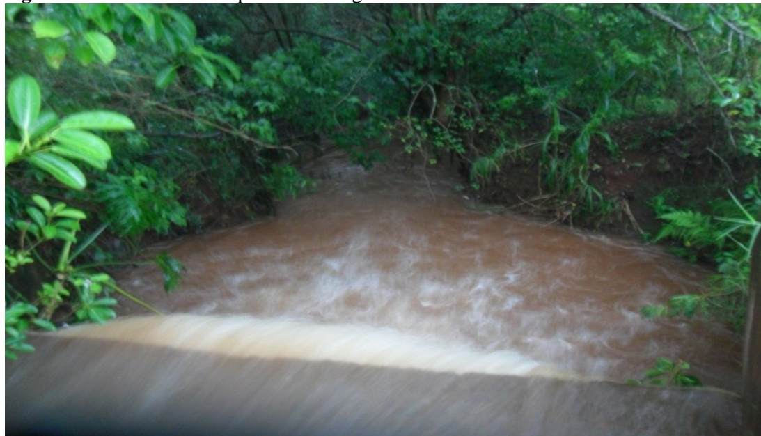
Figura 15 - Calha sem dissipador de energia.
