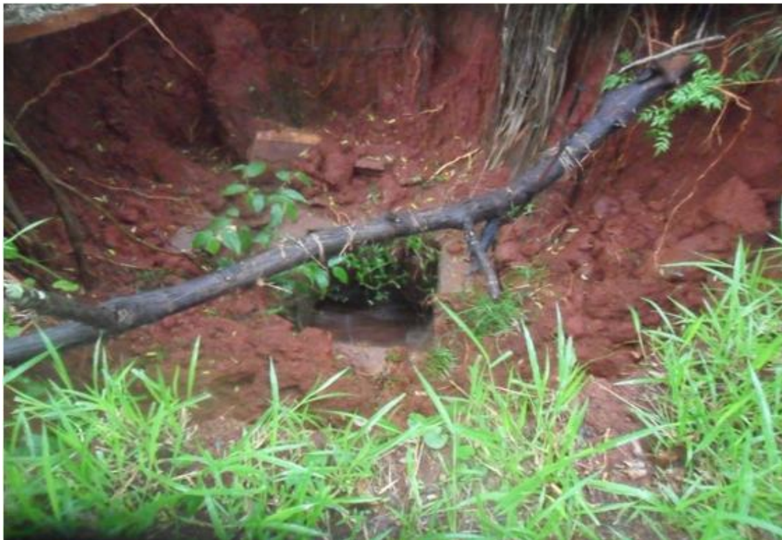
Figura 36 - Ponto 5.6 – Ponto de observação subdimensionado que extravasou com uma precipitação intensa.
