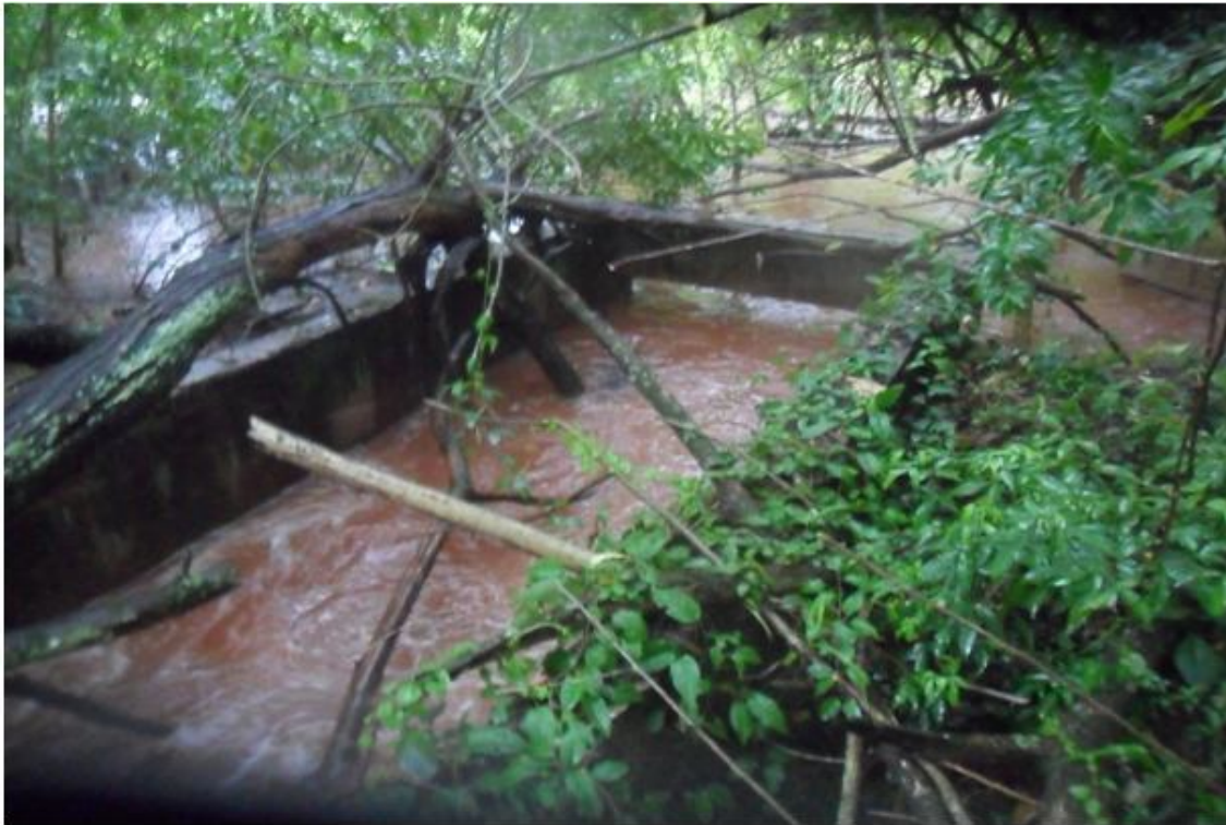
Figura 30 - Ponto 5 - Calha com dissipador de energia por impacto, margem direita do represamento do Córrego Cacique.
