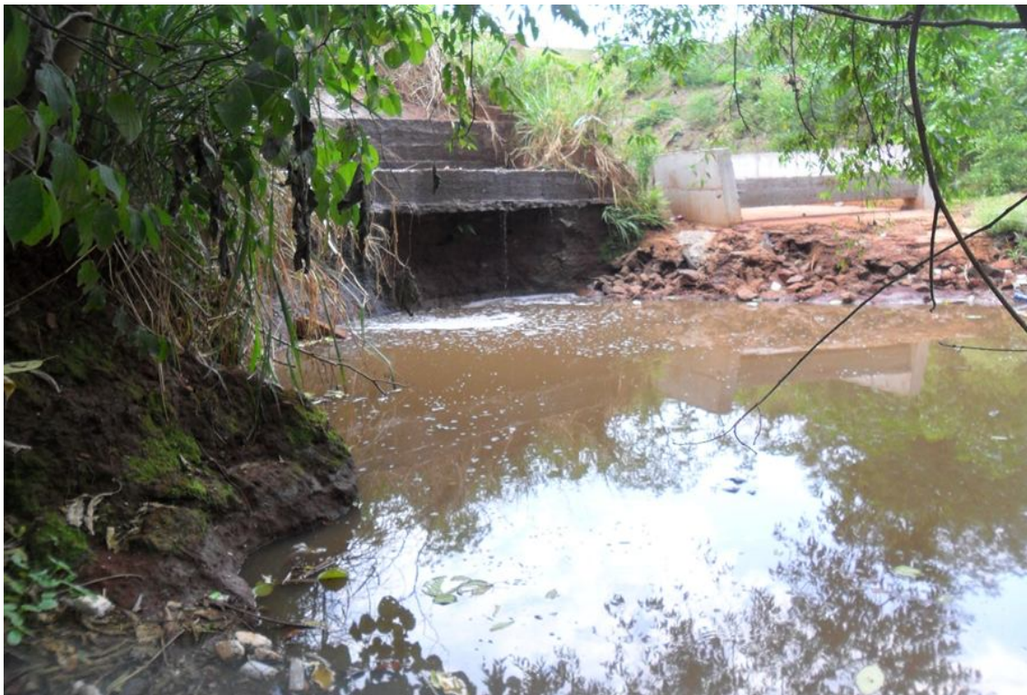
Figura 17 - Calhas de escoamento pluvial concentrado instaladas na nascente do Ribeirão Cambé (a primeira à esquerda sem dissipador de energia).
