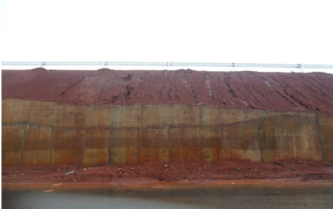
Figura 41 - Ponto 10 – Aterros e processos de ravinamentos na Rodovia Celso Garcia Cid, Cambé-PR.
