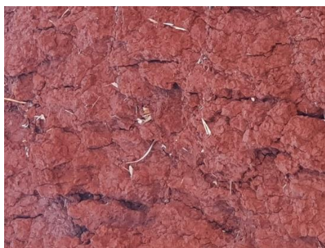
Figura 4 - Latossolo onde se verifica pequenos blocos por onde a água percola
