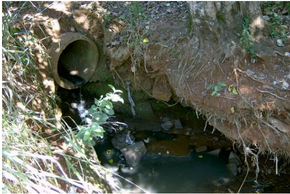
Foto 33 – Um dos pontos de despejo de esgoto no distrito de Irerê. Foto: Parizoto, D.G.V. (2007).
