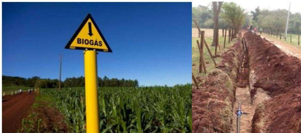
Figura 11 – Placa de sinalização do gasoduto no Ajuricaba
