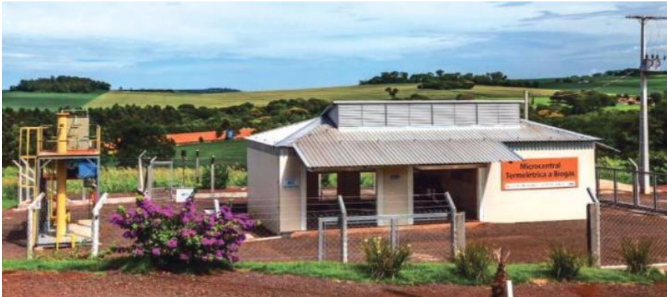
Figura 12 – Central Termelétrica no Ajuricaba
