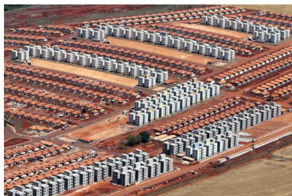
Figura 27 - Residencial Vista Bela em obras. Fonte: Retirado do site da construtora Protenge Engenharia, em 29/07/2014.
