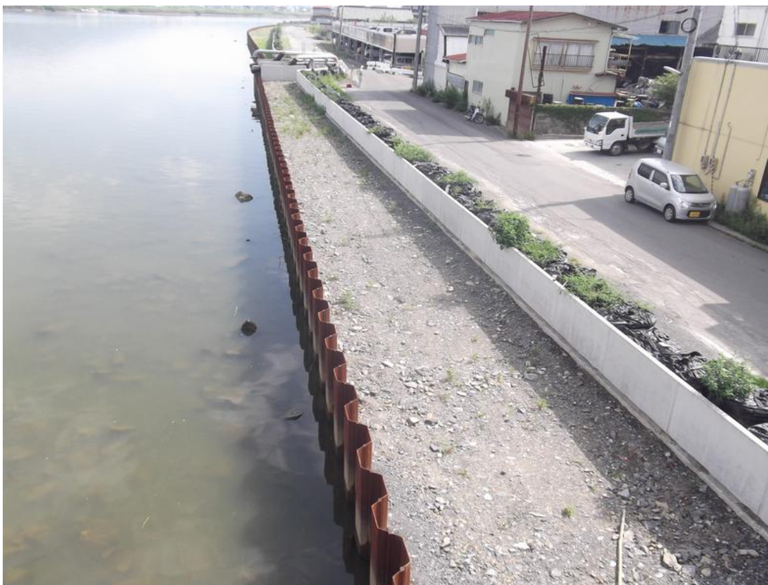
Figura 80: Barreira de isolamento com chapas de ferro em Ishinomaki
