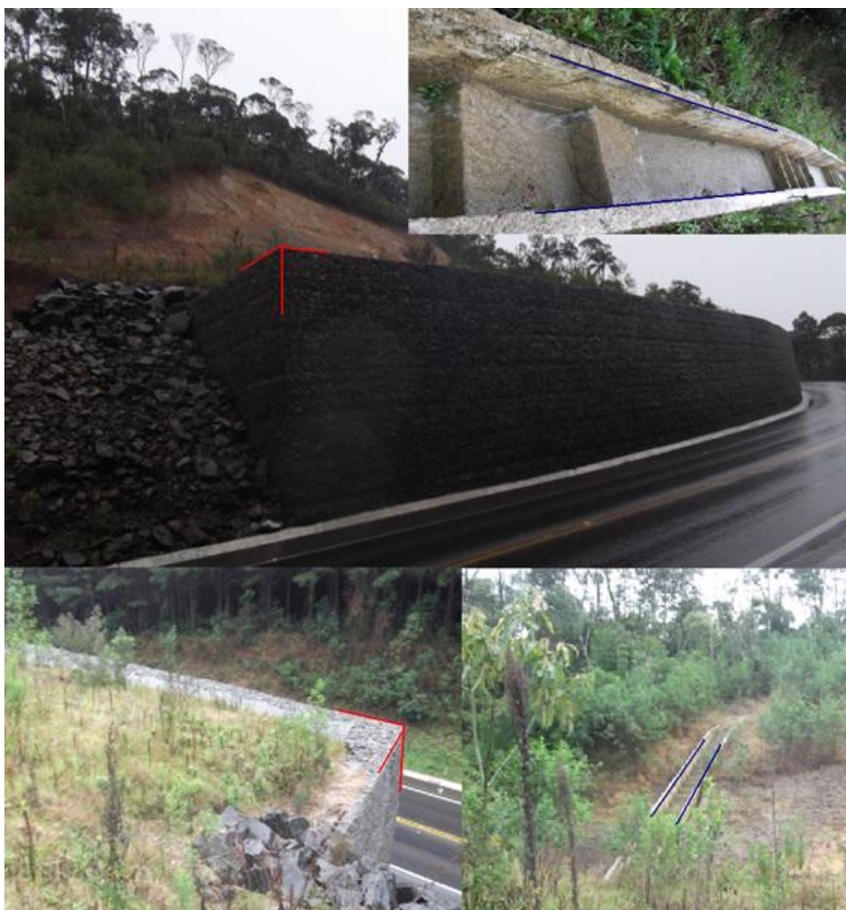
Foto 5 – Barreira contra Deslizamento de terra em Santa Catarina (Foto: Autor, 2013)
