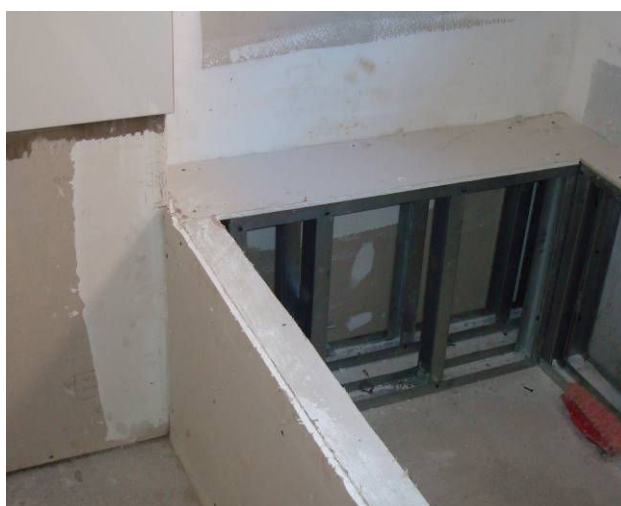
Figura 44 - Reposicionamento da estrutura de apoio para a banheira com a aplicação das placas em gesso acartonado.
