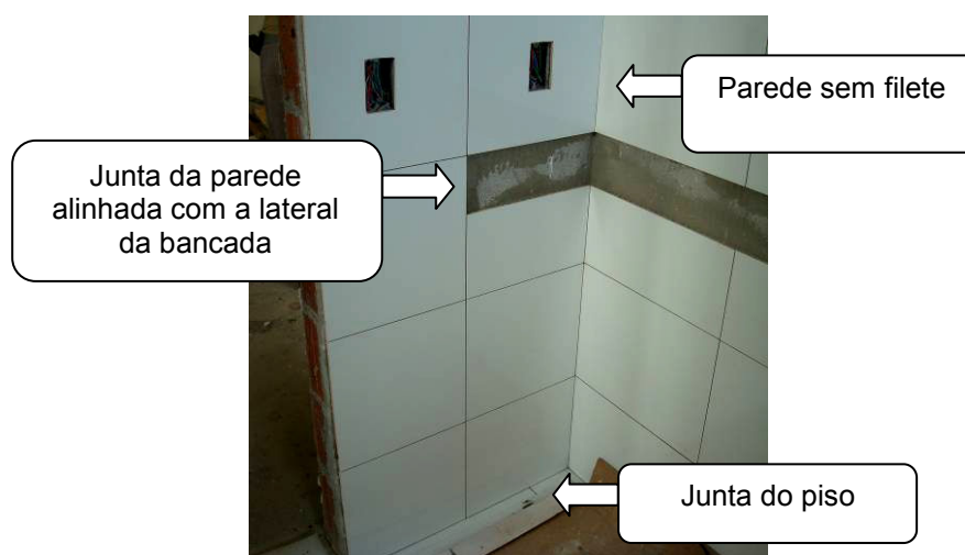
Figura 20 - Parede sem filete e desalinhamento entre juntas de piso e parede
