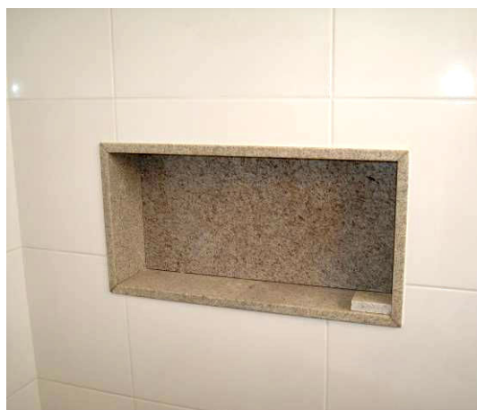
Figura 42 - Alteração no acabamento do nicho
