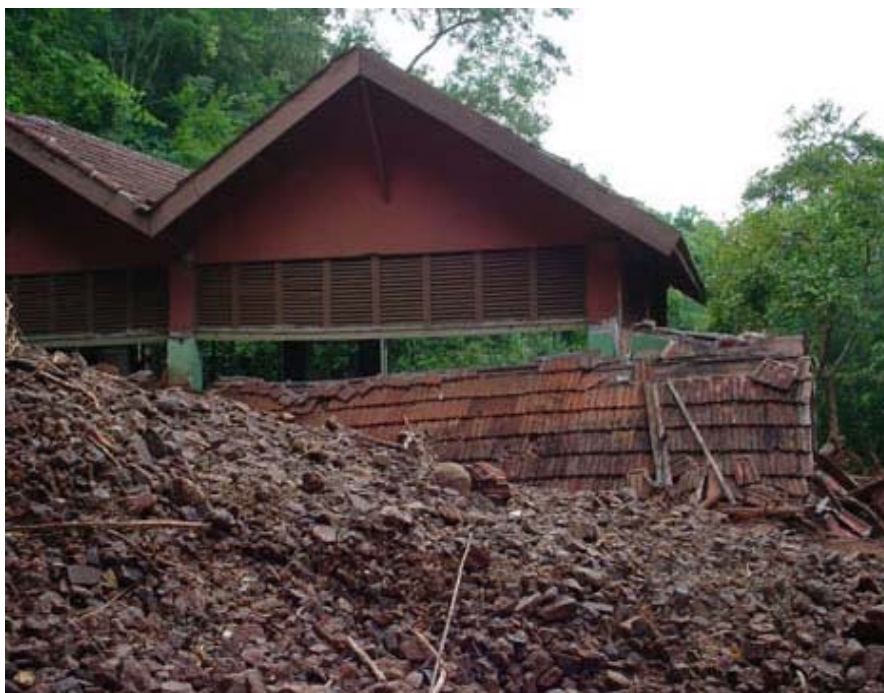
Imagem 30 – Deslizamento nas instalações da Usina em 2005.
