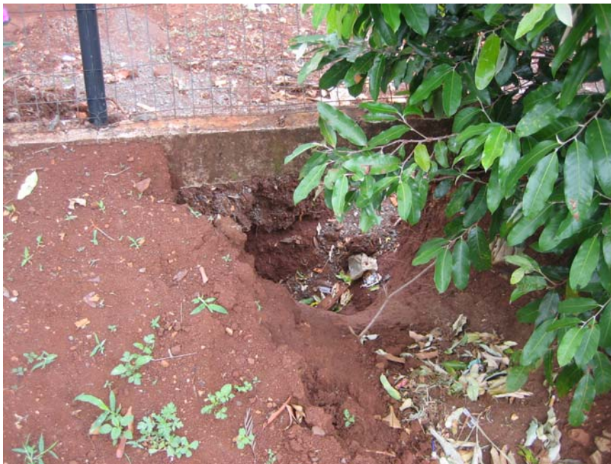
Imagem 29 – Erosão no entorno do PMAT
