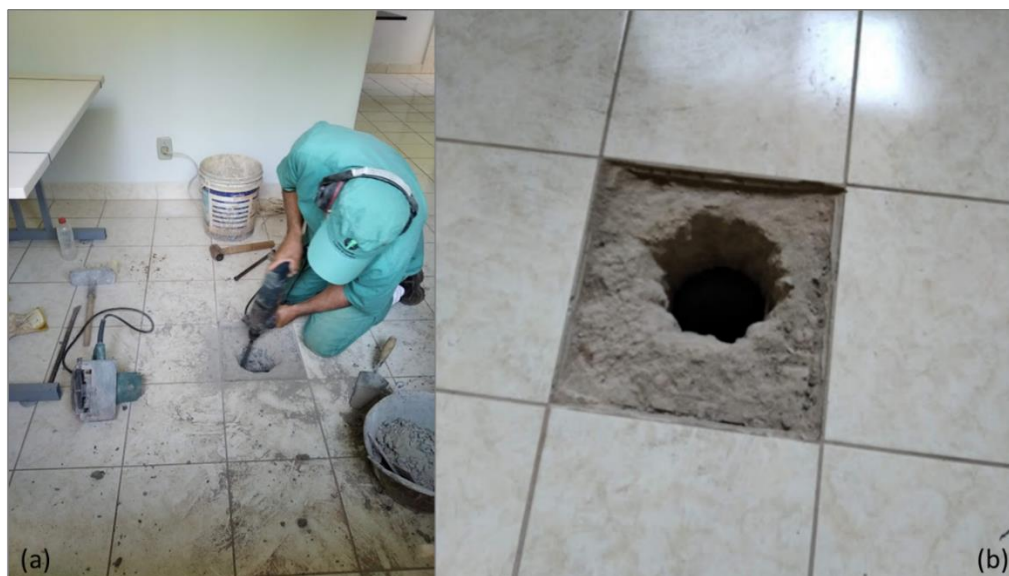
Figura 6 - (a) perfuração do piso; (b) piso perfurado
