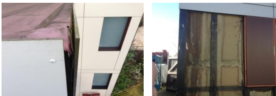
FIGURA 72: Detalhe da manta utilizada na cobertura e das patologias apresentadas nos painéis de madeira
