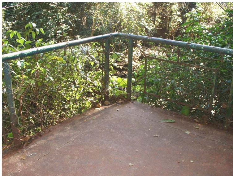
Figura 15 – Guarda-corpo em precário estado de conservação. Autoria: Míriam P. Coradini, 2007.
