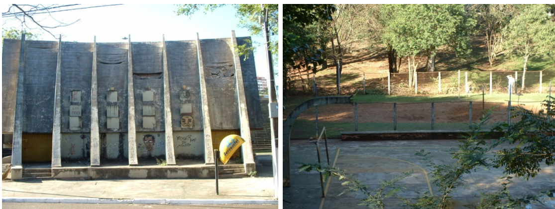
Figura 27 – Exemplos de falta de manutenção no Zerão – anfiteatro interditado por problemas estruturais e quadra esportiva sem condições de uso.
