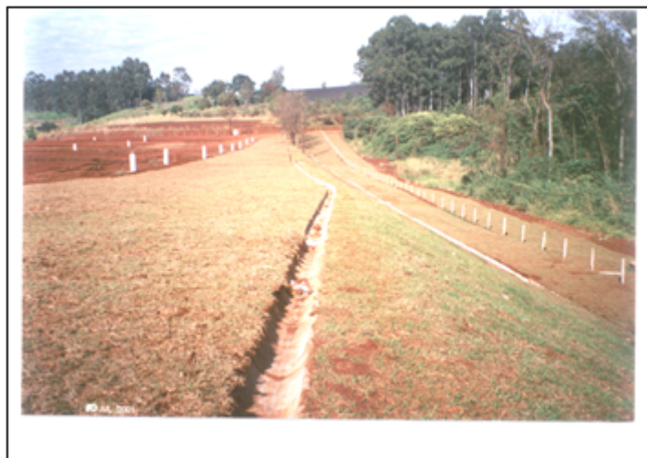
Figura 18 – Detalhe dos drenos de água superficial, linha de drenagem paralela à divisa
