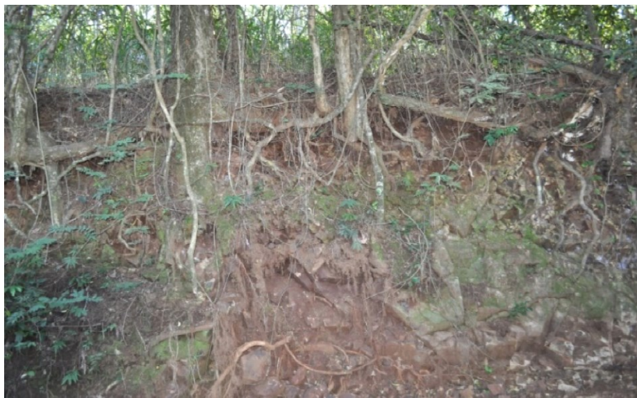
Figura 11 – Ponto 5: Intemperismo em rocha basáltica em corte de estrada
