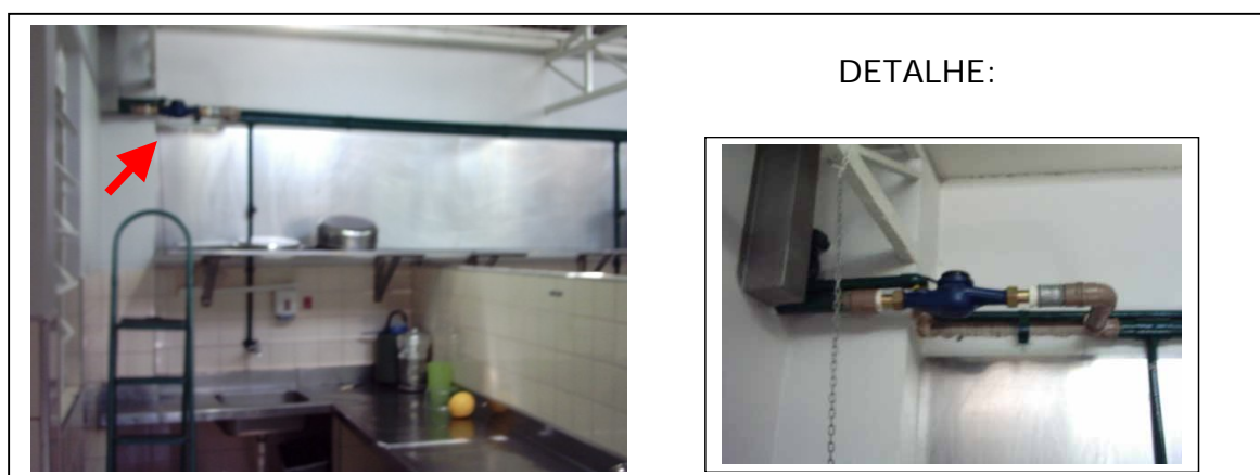
Figura 20 – Empresa “C” - Indicação do local de instalação e detalhe do hidrômetro
