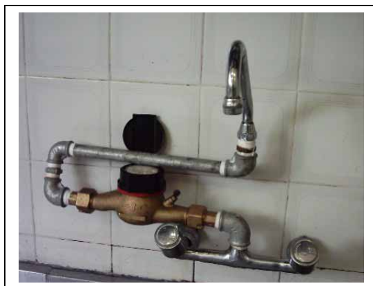
Figura 19 - Empresa “B”- Hidrômetro instalado na saída do misturador
