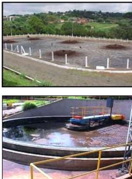
Figura 5 – Lodos ativados e decantador secundário
