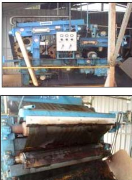
Figura 7 – Vista do início do processo de desaguamento do lodo, por uma prensa desaguadora.
