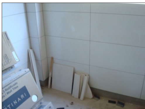
Figura 5 - Sobras de material de revestimento cerâmico
