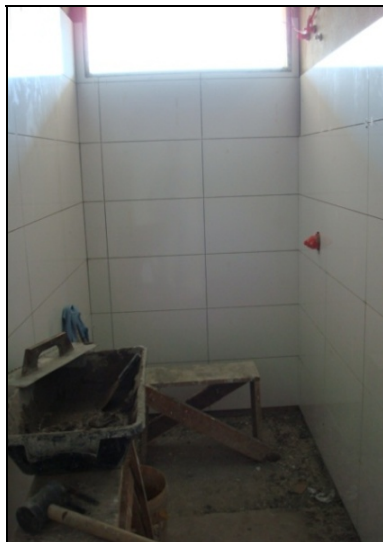
Figura 20 - Falta de compatibilização
