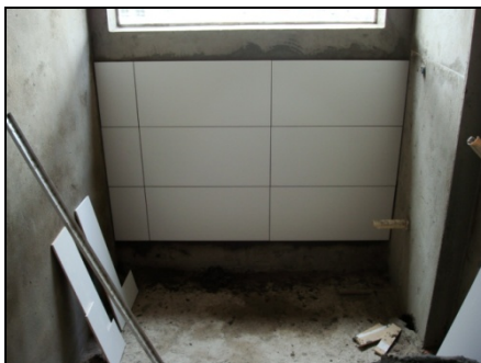
Figura 41 - Falta de Compatibilização
