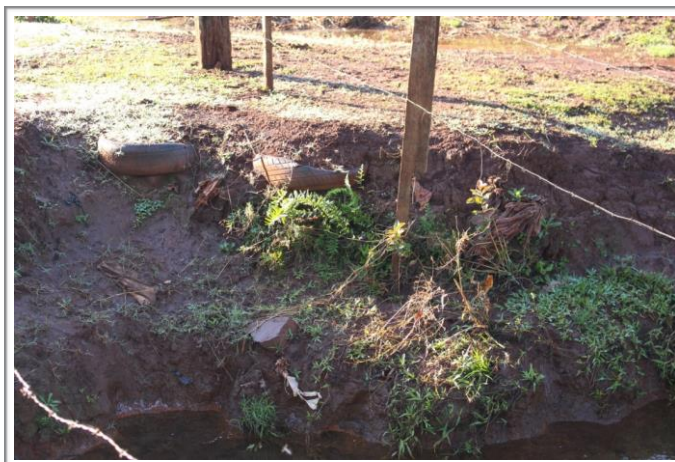
Figura 32: Pneus utilizados para a contenção dos processos erosivos
