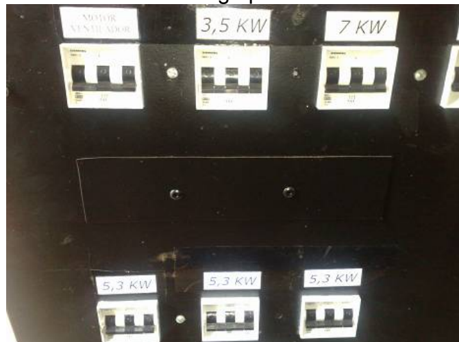
Figura 17 – Banco de carga puramente resistiva trifásica
