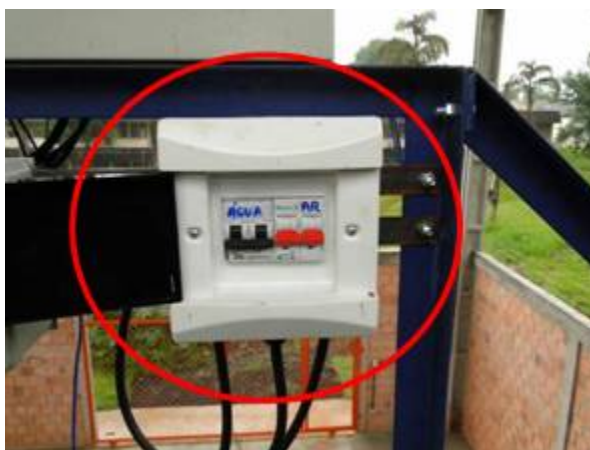
Figura 16 – Disjuntores dos sistemas de ar comprimido e refrigeração
