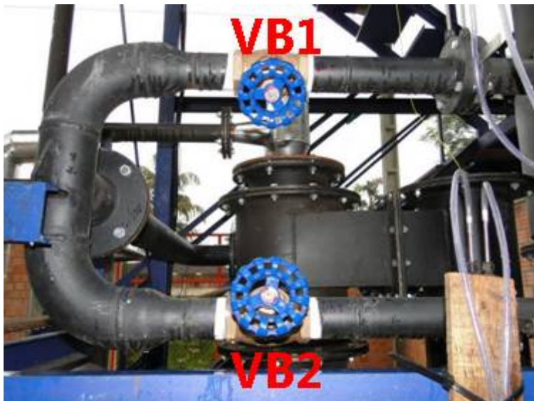
Figura 6 – Válvulas VB1 e VB2, de regulagem da quantidade de ar de entrada nos 2 estágios de gaseificação
