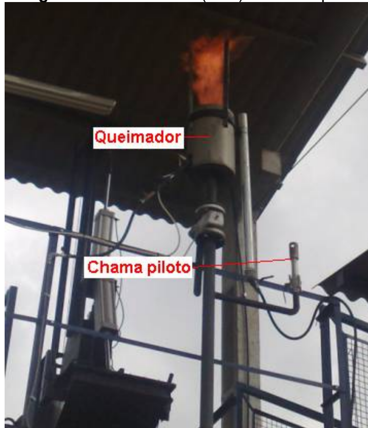
Figura 12 – Queimador (flare) e “chama piloto”
