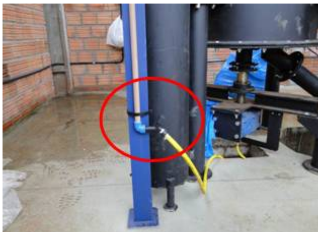
Figura 13 – Registro de água do resfriamento da grelha
