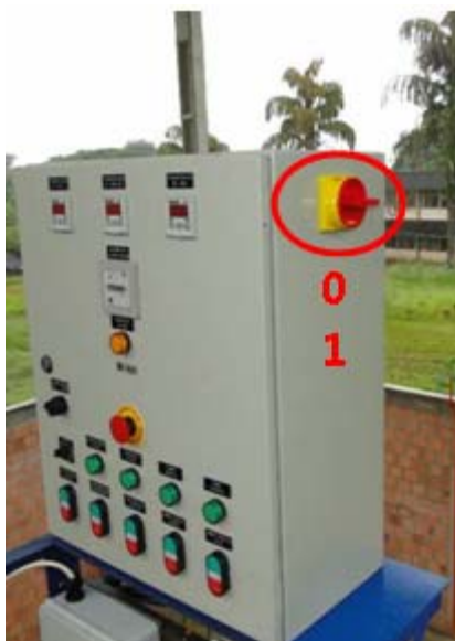
Figura 2 – Quadro de comando do gaseificador
