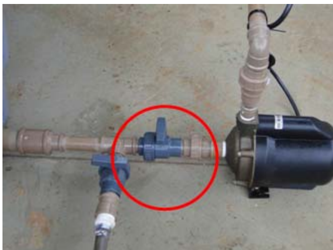
Figura 11 – Registro (detalhe) de liberação da água para trocadores de calor, grelha e torre de resfriamento e registro de abastecimento do tanque de armazenamento
