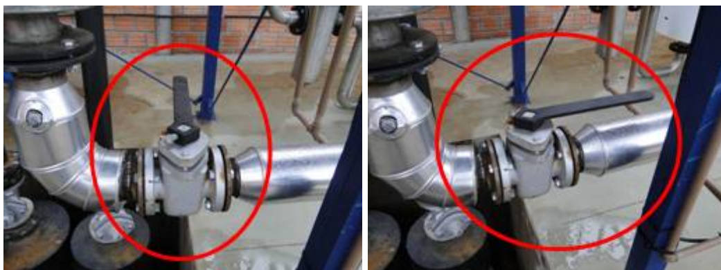
Figuras 7 e 8 – Válvulas de liberação do gás (na posição fechada e aberta respectivamente) para o gasômetro e posterior uso
