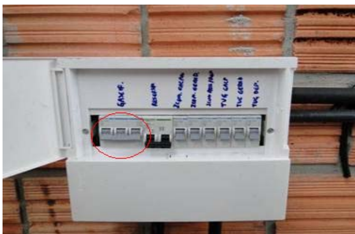
Figura 1 - Quadro de disjuntores
