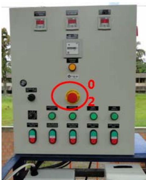
Figura 3 – Quadro de comando do gaseificador
