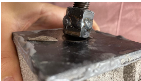
Figura 131 – Falha na solda
