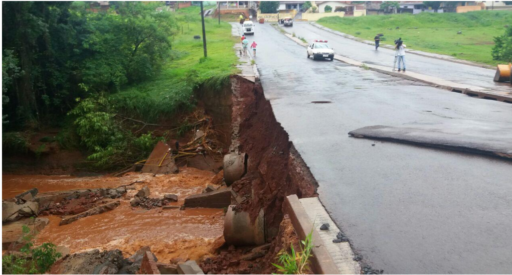
Figura 25 - Ponte Interditada após Forte Chuva (30/12/2016)
