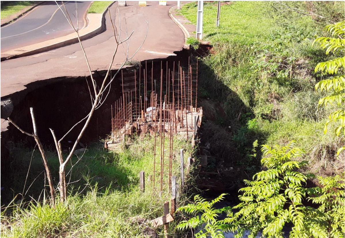
Figura 24 - Problemas de Infraestrutura – Jd. Olímpico (Londrina)
