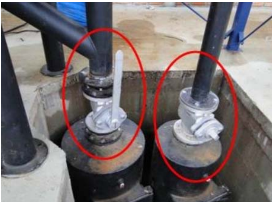
Figura 18 – Válvulas do silo de carvão e do silo do ciclone, respectivamente
