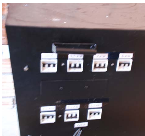
Figura 24 – Banco de cargas
