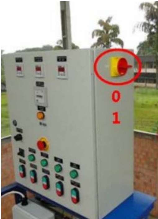
Figura 2 – Quadro de comando do gaseificador
