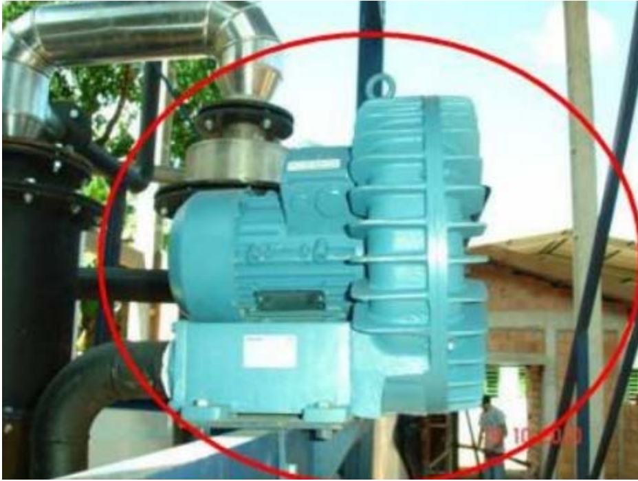
Figura 4 – Soprador de ar: ventilador que injeta ar nos estágios de gaseificação
