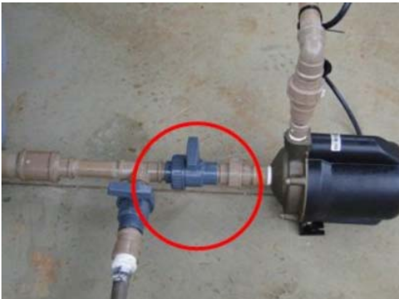
Figura 11 – Registro (detalhe) de liberação da água para trocadores de calor, grelha e torre de resfriamento e registro de abastecimento do tanque de armazenamento
