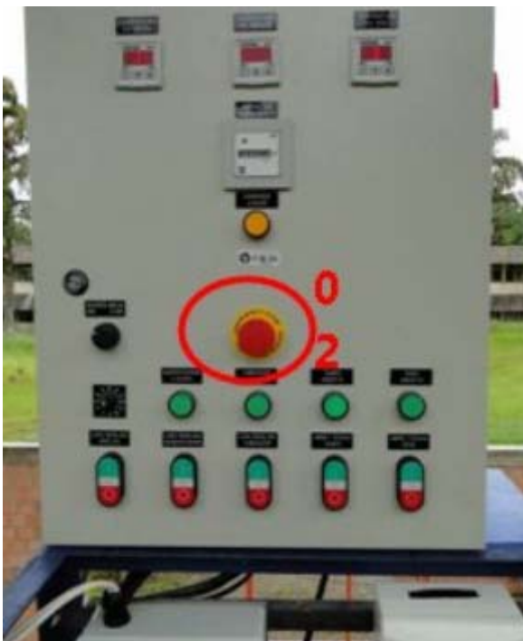
Figura 3 – Quadro de comando do gaseificador
