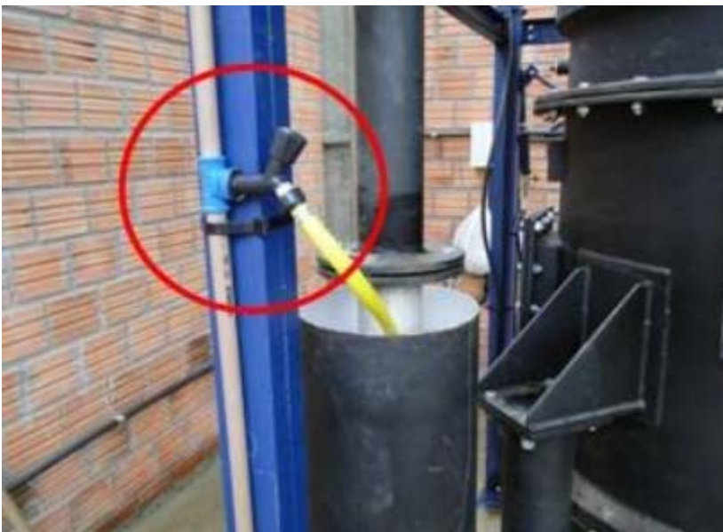
Figura 14 – Registro de abastecimento de água do selo d'água
