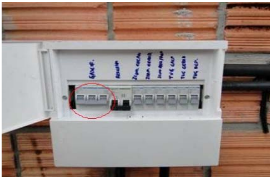
Figura 1 – Quadro de disjuntores
