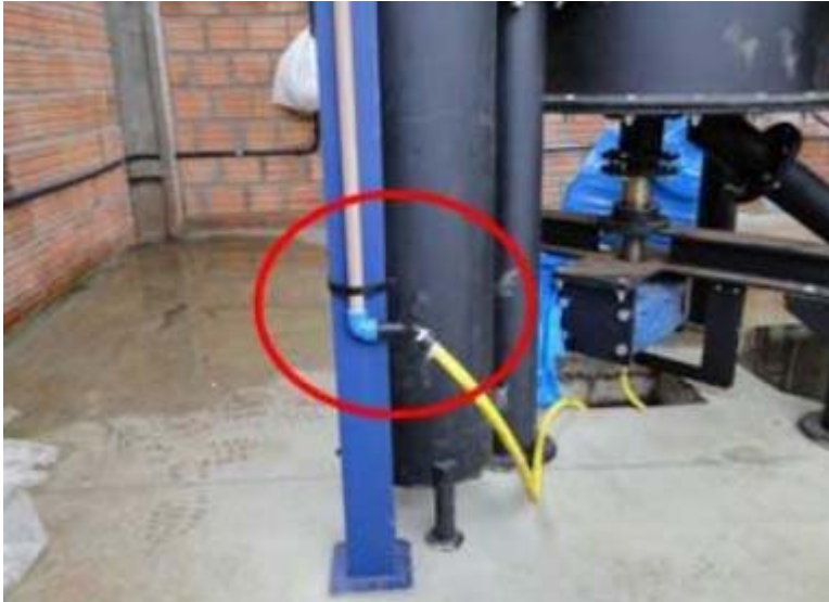
Figura 13 – Registro de água do resfriamento da grelha
