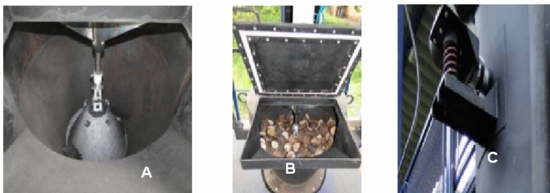
Figura 15 – Válvula sino (A), Silo superior carregado (B) e Sistema de vibração
