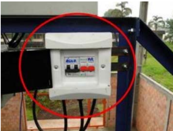
Figura 16 – Disjuntores dos sistemas de ar comprimido e refrigeração
