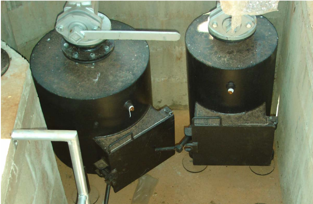
Figura 16 – Reservatórios de cinzas e de material particulado.
