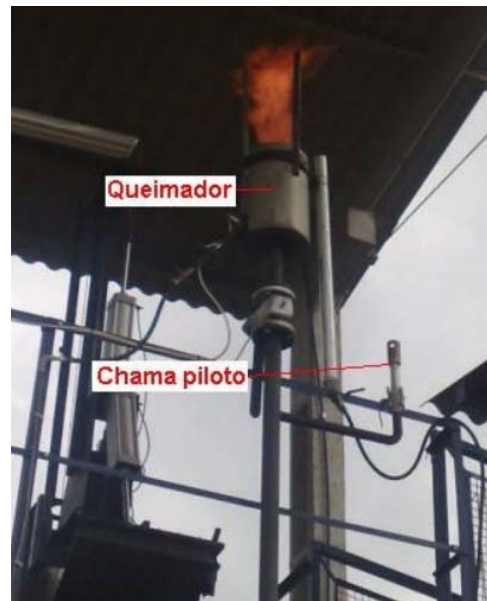
Figura 19 – Queimador e queimador piloto
